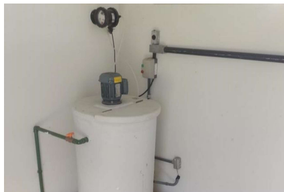
Figura 13 - Sistema de cloração da ETE
