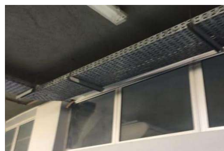
Figura 51 - Eletrocalhas e janelas para as salas no térreo
