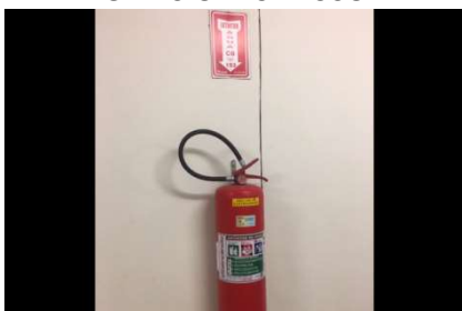
Figura 92 - Extintores do COMPLEXO no prazo de validade
