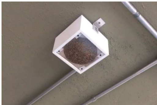
Figura 90 - Caixas de som ambiente do GINÁSIO MULTIUSO
