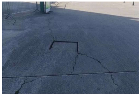
Figura 141 - Patologia no piso de concreto do ESTACIONAMENTO DE SERVIÇO
