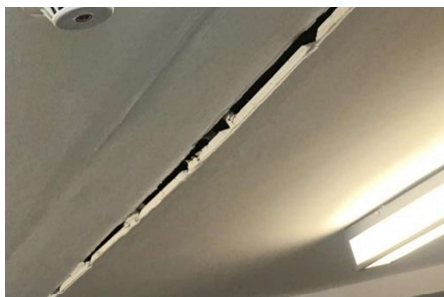
Figura 38 - Detalhe do selamento do forro da Sala do Acervo pela vibração da casa de máquinas logo acima
