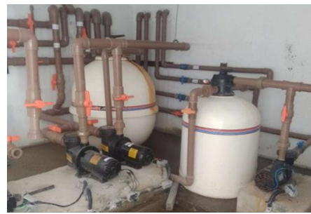
Figura 125 - Bombas, filtros e instalações na área da PISCINA
