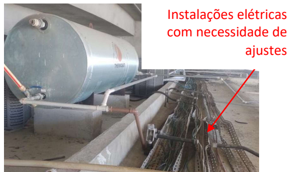
Figura 59 - Boiler de água quente dos vestiários dos atletas e instalações elétricas com necessidades de reparos
