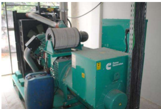
Figura 10 - Subestação - Grupo Motor gerador
