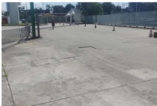
Figura 136 – Piso do ESTACIONAMENTO DE SERVIÇO necessitando de reparos
