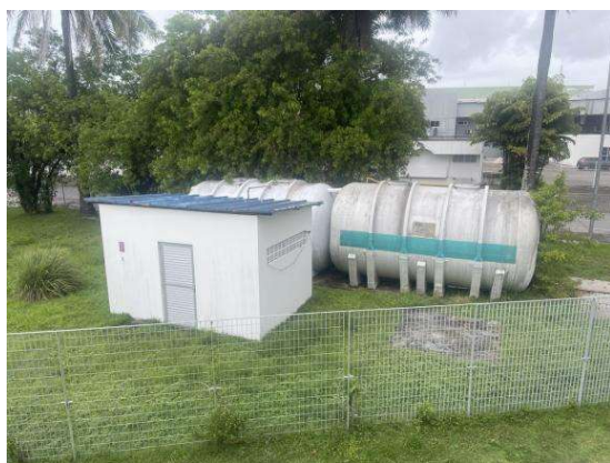
Figura 11 - Estação de tratamento de esgoto (ETE)
