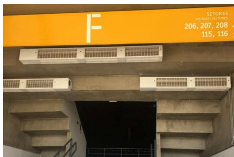
Figura 101 - Cortinas de ar do pavimento intermediário
