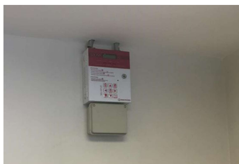
Figura 89 - Central de alarme
