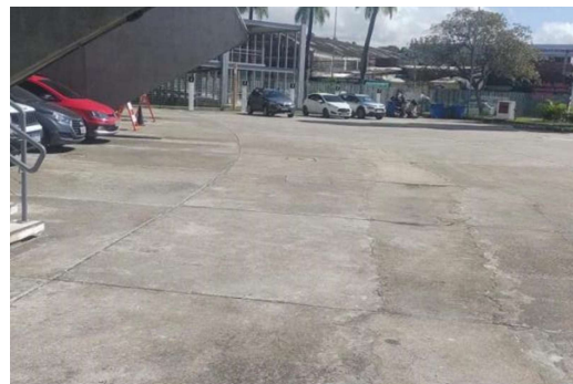
Figura 139 – Vagas para imprensa e visão do piso do com a necessidade de reparos
