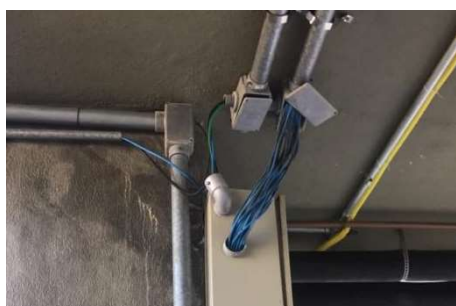
Figura 50 - Instalações de dados aparentes no corredor térreo
