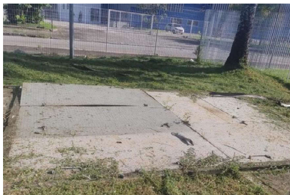
Figura 12 - Poço de recebimento da ETE, devidamente coberto com alçapão
