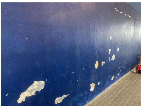
Figura 116 – Parede entre as QUADRAS POLIESPORTIVAS necessitando de reparo
