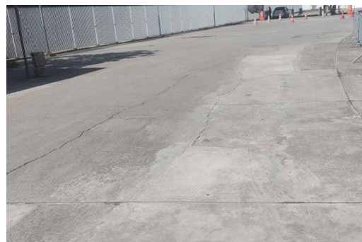
Figura 137 – Piso do ESTACIONAMENTO DE SERVIÇO necessitando de reparos
