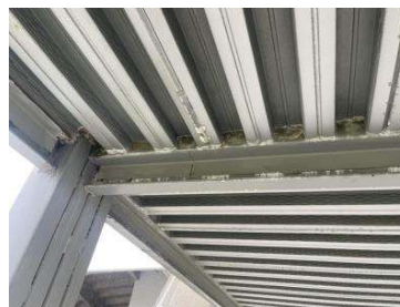
Figura 27 - Corrosão na cobertura das rampas de acesso
