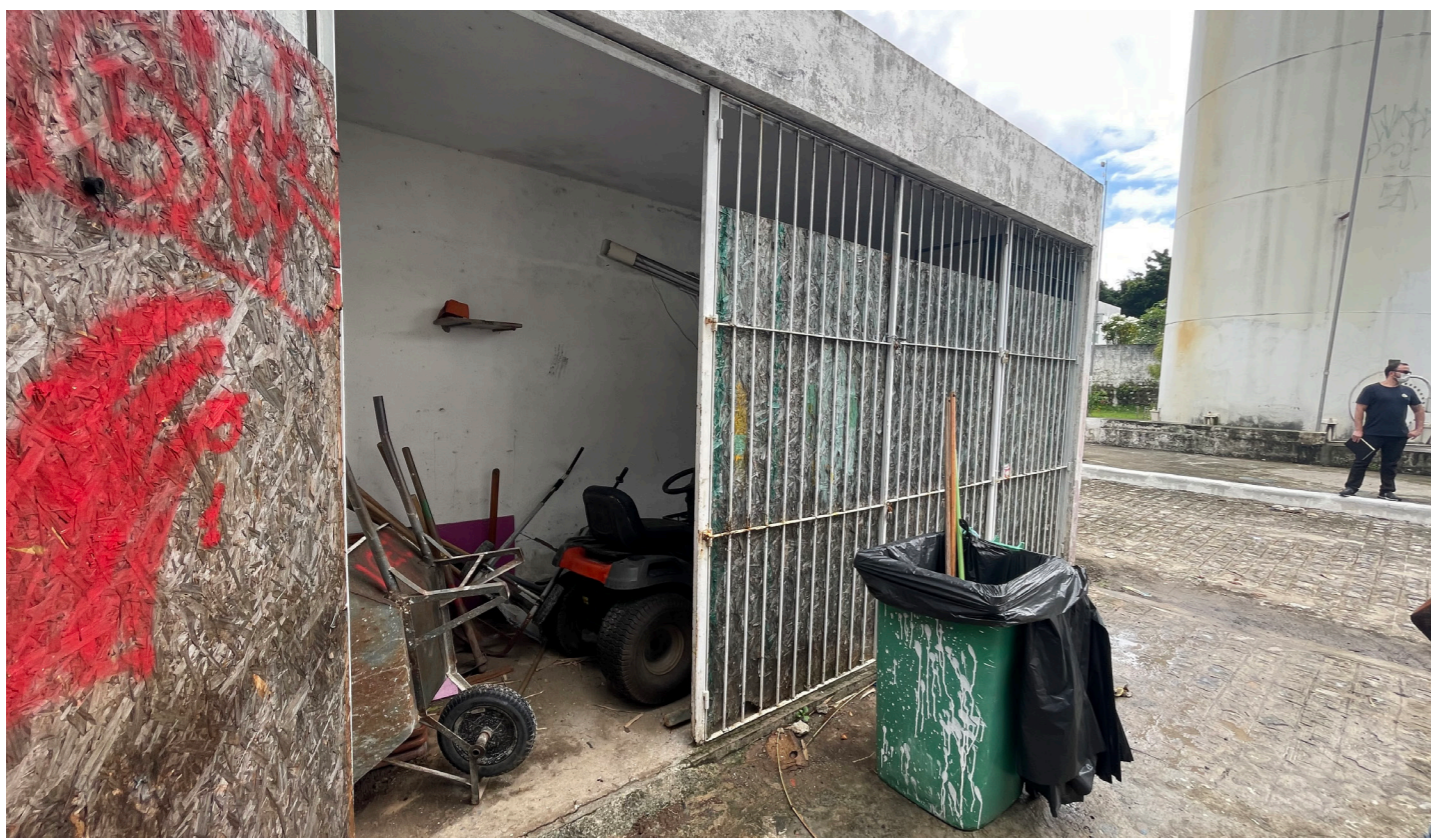
Figura 61 — Foto da edificação. Fonte: visita técnica feita pela equipe em agosto de 2021
