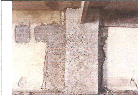
Foto 23: Evidência de pilares com aplicação de chapisco
