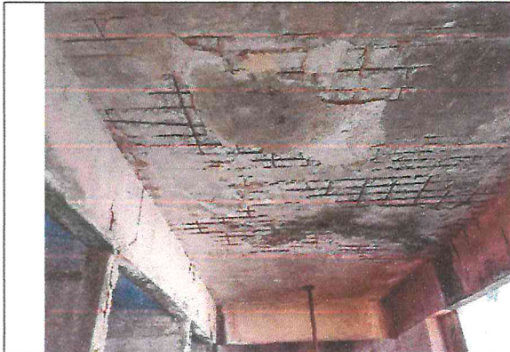
Foto 21: Desgaste de lajes onde se observam queda de revestimentos e exposição de armaduras
