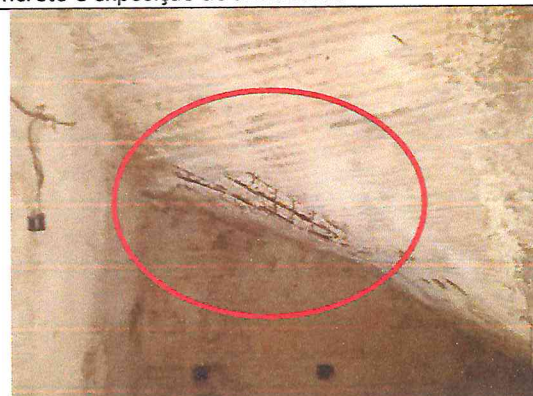
Foto 07: Queda de revestimentos e armaduras expostas pela face posterior da escada
