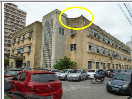
Rua Dr. José Henrique Wanderley e Rua Ulhoa Cintra, 2017. Fonte: DPPC. Percebe-se uma alteração na platibanda do imóvel devido às mudanças em sua cobertura.
