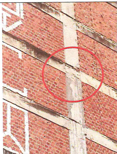
Foto 03: Desprendimentos de revestimentos de pilar.
