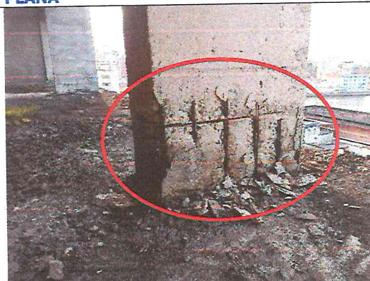
Foto 16: Patologias nas bases dos pilares
