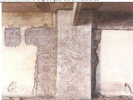
Foto 23: Evidência de pilares com aplicação de chapisco
