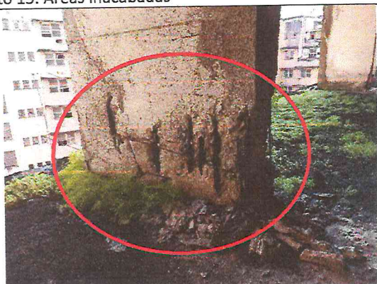
Foto 17: Patologias nas bases dos pilares
