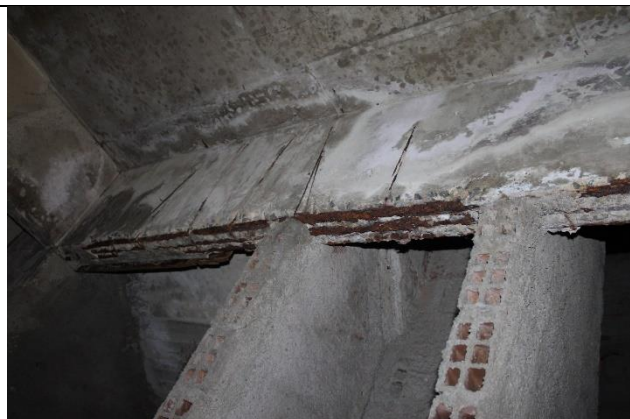
Foto 07: Vergas com danos estruturais e exposição de armaduras oxidadas
