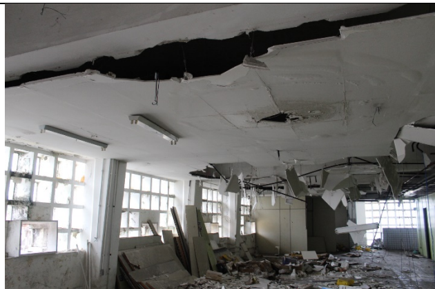
Foto 41: Colapso parcial de forro em gesso, pontos de infiltrações, acúmulo de entulhos
