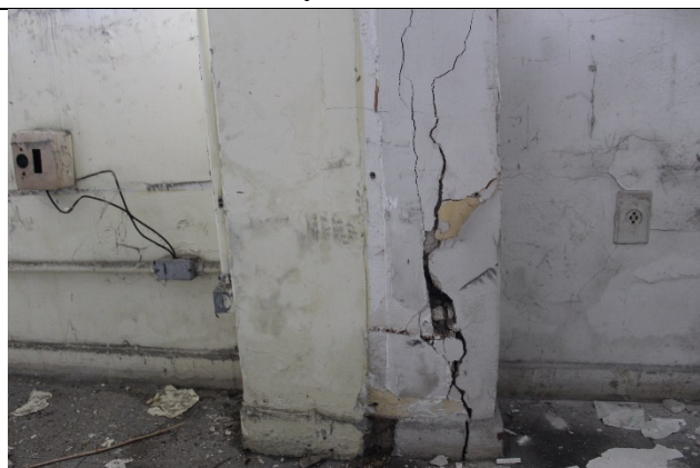
Foto 33: Fissuras em pilar sugerindo oxidação de armaduras, em área de junta de dilatação
