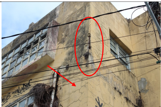
Foto 08: Fissuras em revestimentos e exposição de armaduras oxidadas em pilar
