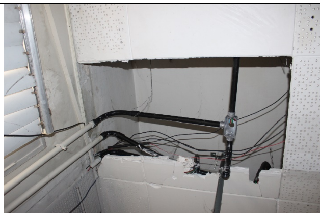
Foto 37: Exposição de fiação elétrica
