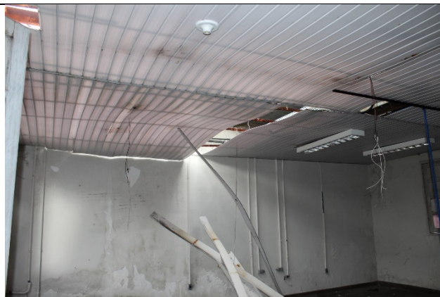
Foto 28: Colapso parcial e forro PVC
