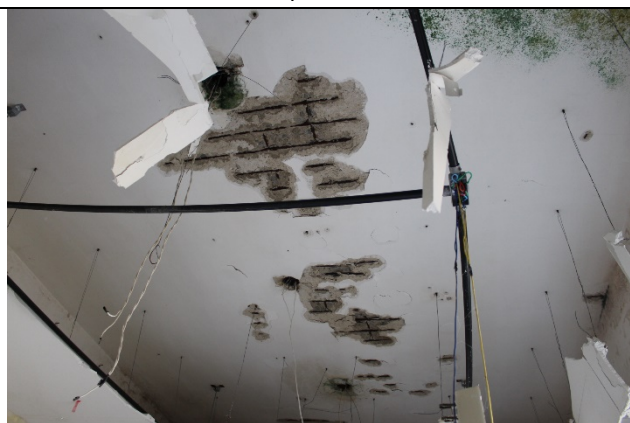
Foto 31: Colapso parcial de forro em gesso, desprendimentos de revestimentos e exposição de armaduras oxidadas de laje
