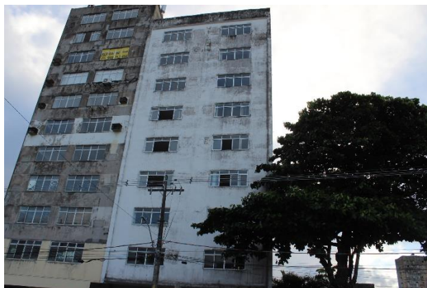
Foto 02: Incidência de infiltrações, levando à alteração dos revestimentos de fachada
