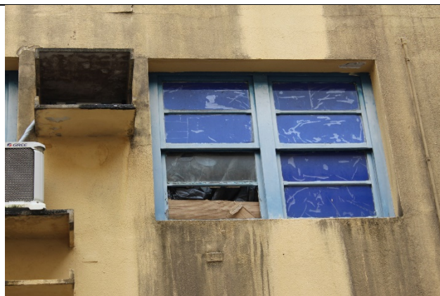
Foto 18: Danos em esquadrias, umidade
