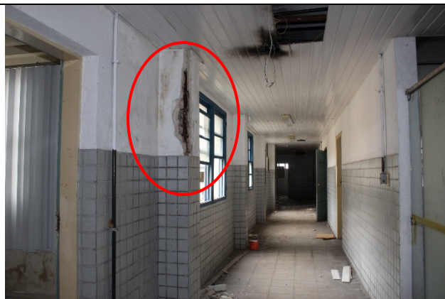
Foto 44: Vista para circulação interna com desprendimento de revestimento de pilar e infiltrações
