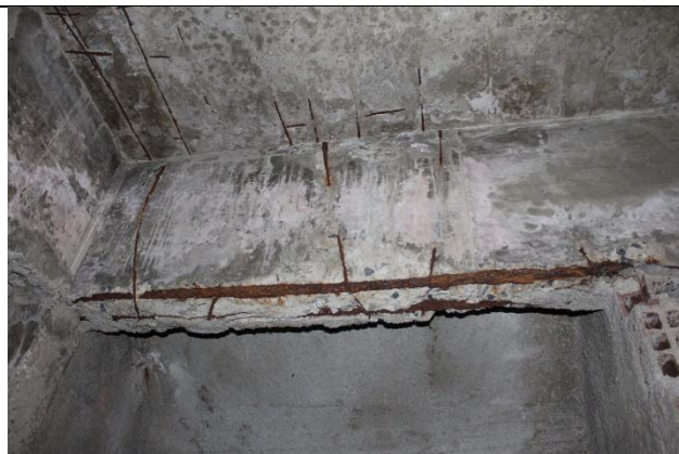
Foto 08: Vergas com danos estruturais e exposição de armaduras oxidadas
