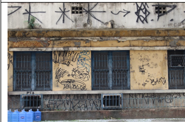
Foto 09: Desgastes de revestimentos, fissuras, infiltrações
