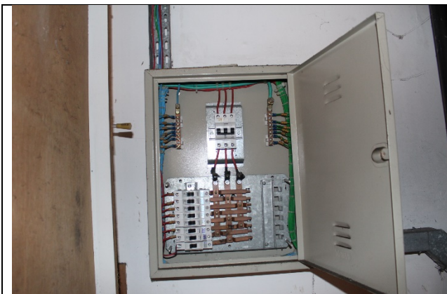
Foto 47: Vista do quadro de disjuntor predial
