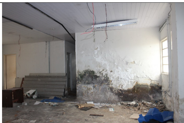
Foto 25: Infiltrações em áreas internas; proliferação de lodo e danos em revestimentos
