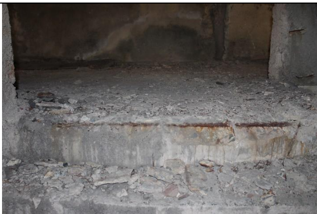
Foto 05: Escada – Danos em degraus com exposição de armaduras oxidadas, sugerindo camada de recobrimento insuficiente
