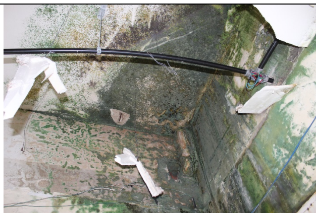
Foto 32: Infiltrações recorrentes em laje, com proliferação de lodo e umidade
