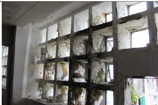
Foto 39: Desgastes severos de cobogós em concreto armado
