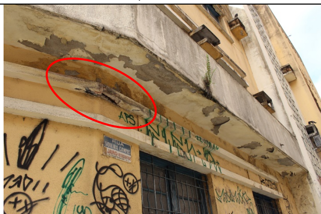
Foto 10: Desgastes de revestimentos, fissuras, exposição de armaduras oxidadas
