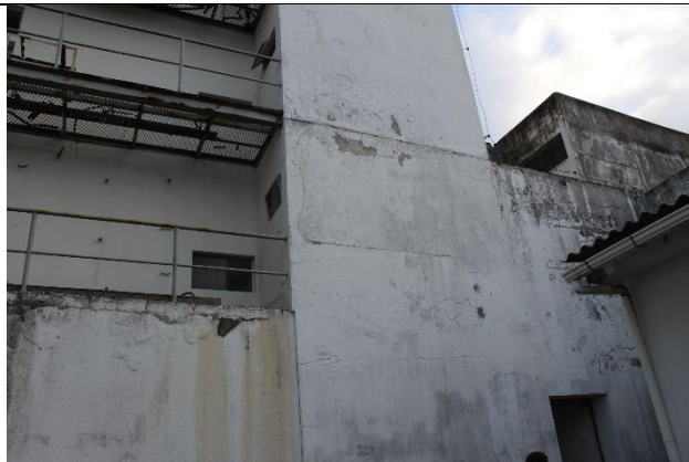
Foto 04: Manchas e avarias em revestimentos de fachada por infiltrações
