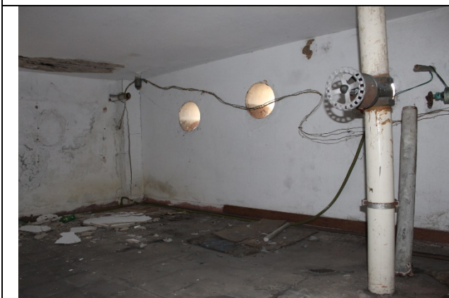
Foto 49: Vista para tubulação de reservatório superior
