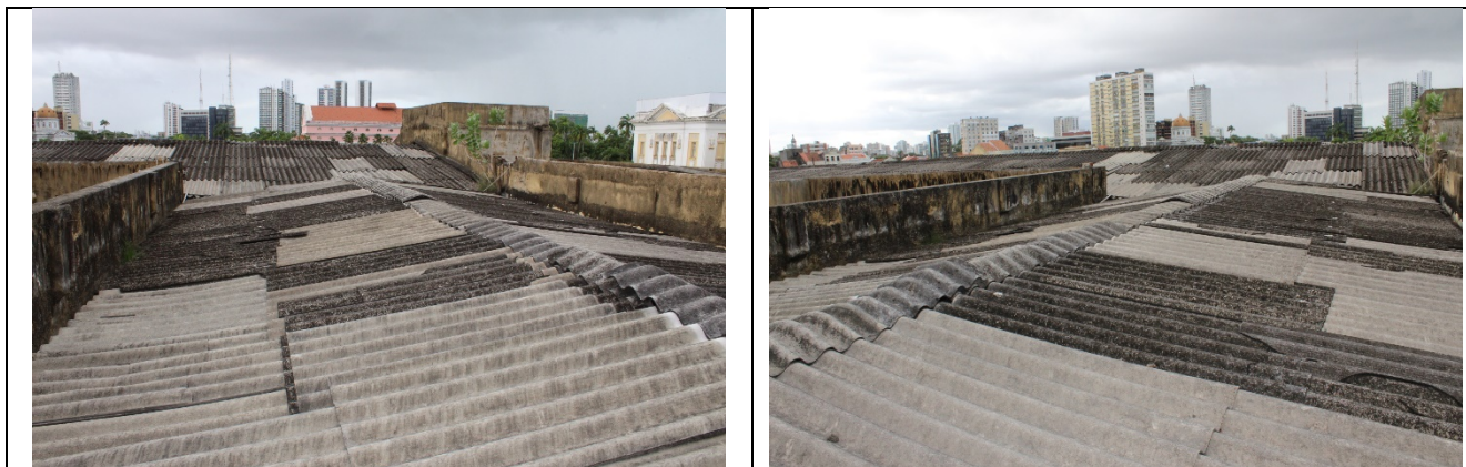
Fotos 23 e 24: Cobertura observada de forma parcial: infiltrações internas sugerem danos em elementos
