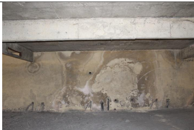
Foto 14: Manchas de infiltrações incidentes nas alvenarias de vedação e alvenarias internas
