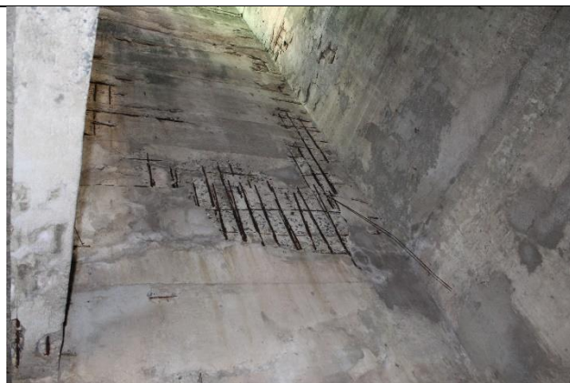
Foto 22: Vista interna de caixa de elevador com danos estruturais severos
