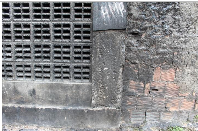
Foto 04: Manchas de fuligem, queda de revestimentos
