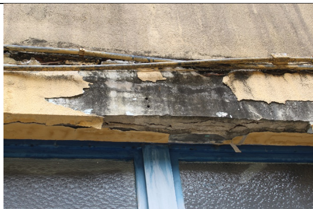
Foto 19: Verga apresenta danos estruturais
