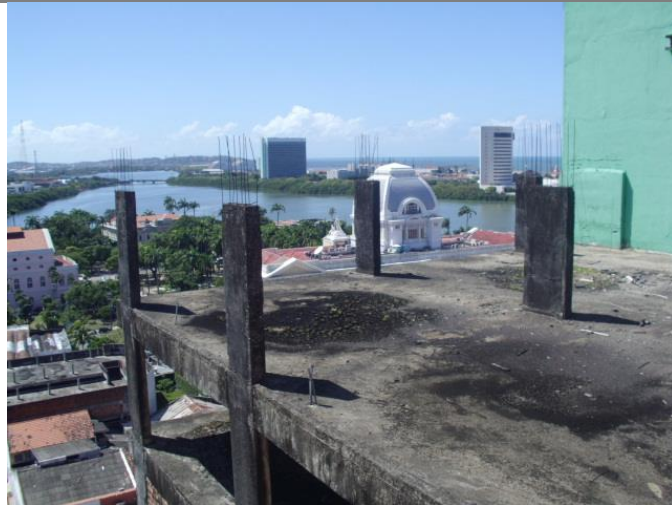
Vista para estrutura do imóvel S/N, notam-se ferragens aparentes indicando a construção pendente dos últimos pavimentos, 2011. Fonte: Acervo DPPC.
