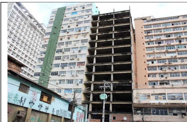
Foto 01: Fachada principal – edificação inacabada e sem afastamentos
