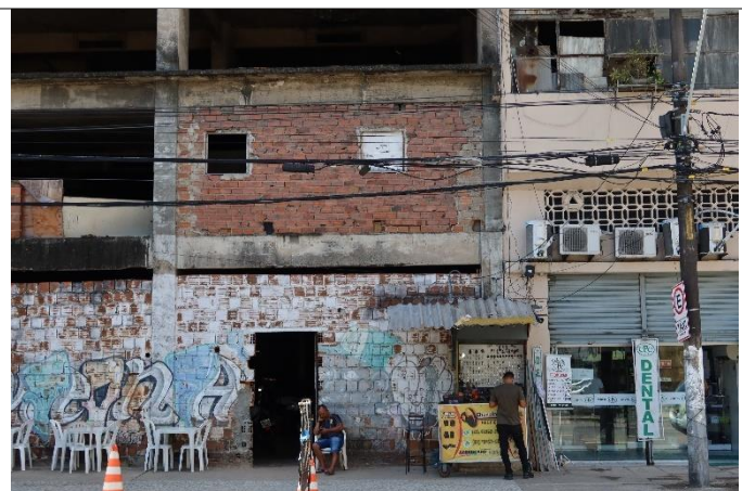
Notam-se intervenções não-licenciadas de fechamento do 1º pavimento, criação de aberturas e uso de estacionamento no térreo do imóvel S/N.
