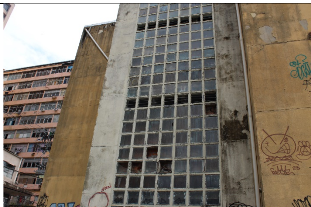
Foto 06: Quebra de vidraças
