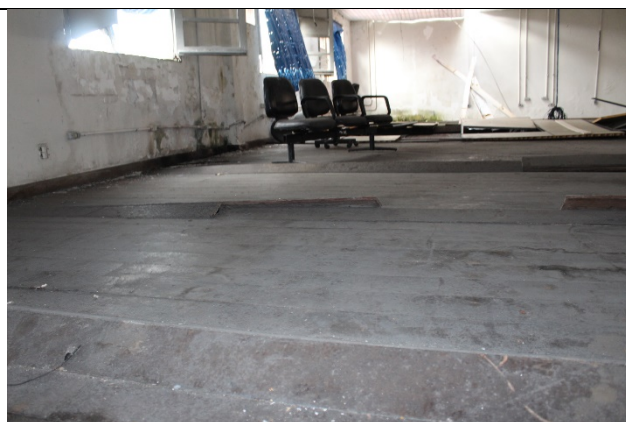
Foto 26: Desprendimento de revestimentos de pisos
