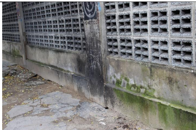
Foto 03: Desgastes de revestimentos, ascensão capilar de água
