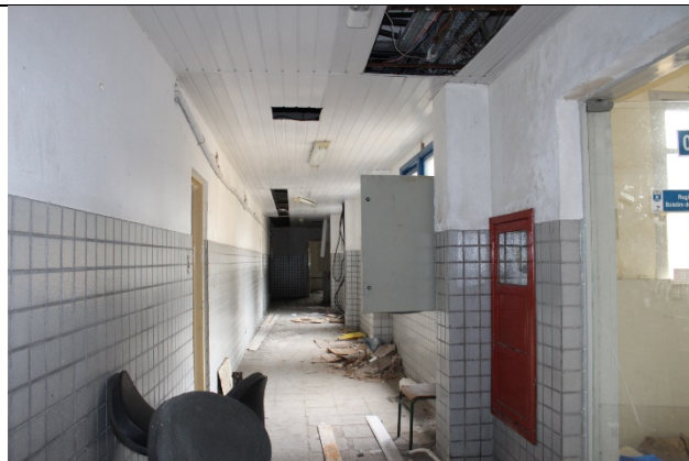
Foto 42: Vista para circulação interna com colapso parcial de forro PVC
