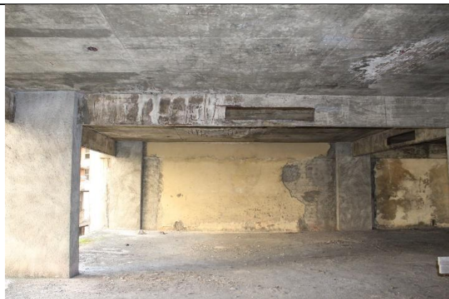
Foto 13: Manchas de infiltrações incidentes nos elementos resistentes
