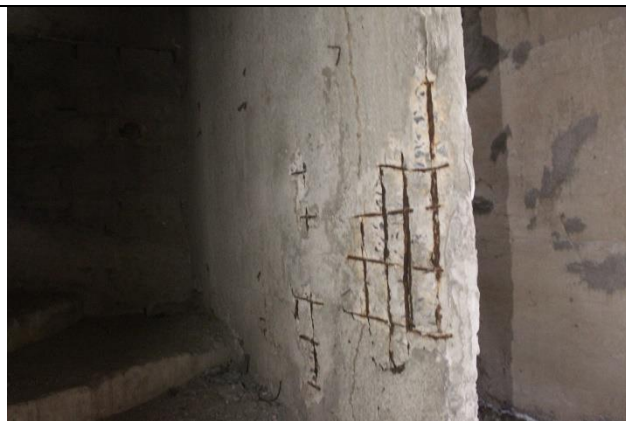
Foto 06: Paredes com danos estruturais e exposição de armaduras oxidadas
