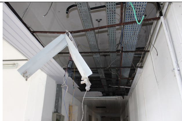
Foto 38: Oxidação de eletrocalhas (quando existentes)
