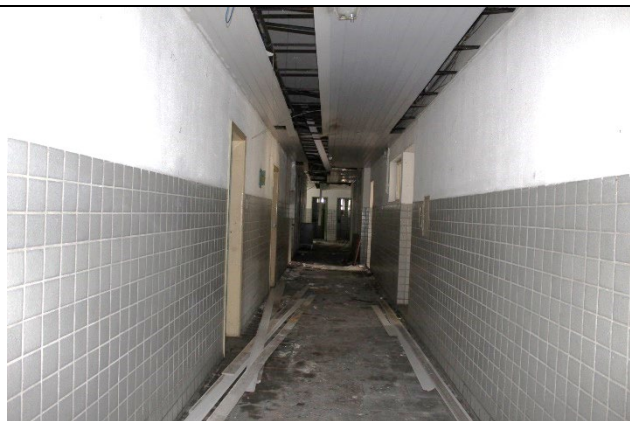
Foto 43: Vista para circulação interna com colapso parcial de forro PVC
