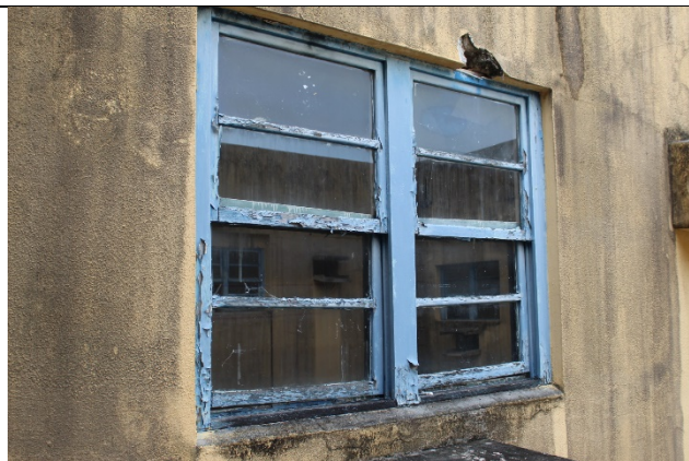
Foto 21: Danos em esquadrias de madeira de janelas
