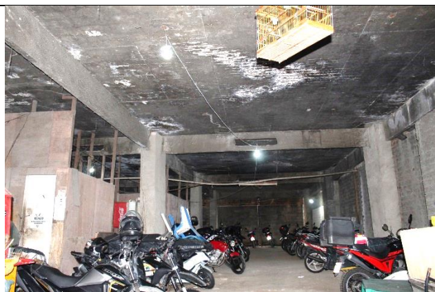
Foto 02: Vista interna, pavimento térreo – local utilizado como estacionamento de motos. Danos em laje
