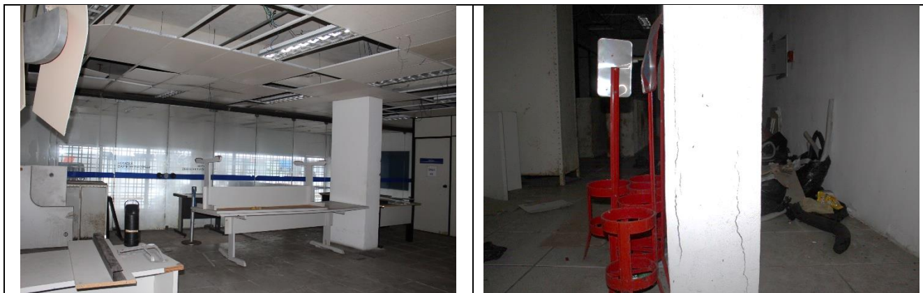
Fotos 23 e 24: O pavimento térreo possui acúmulo de materiais em relação aos demais pavimentos, onde se observa dano em pilar próximo aos elevadores, sugerindo oxidação de armaduras
