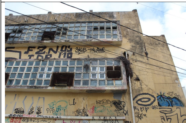
Foto 07: Quebra de vidraças, desgastes de revestimentos
