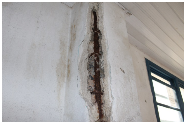
Foto 29: Desprendimentos de revestimentos e exposição de armaduras oxidadas de pilar
