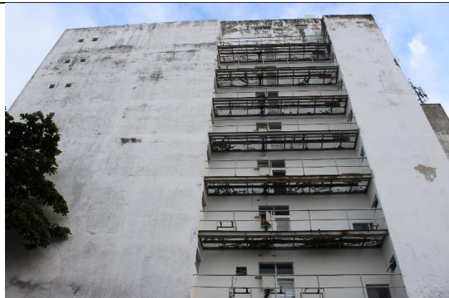
Foto 03: Fachada lateral: oxidação de elementos metálicos de varandas
