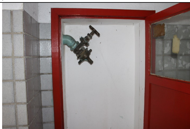
Foto 50: Sistema de combate a incêndio inoperante
