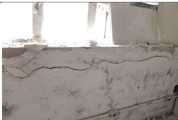
Foto 34: Fissura horizontal em contra-verga
