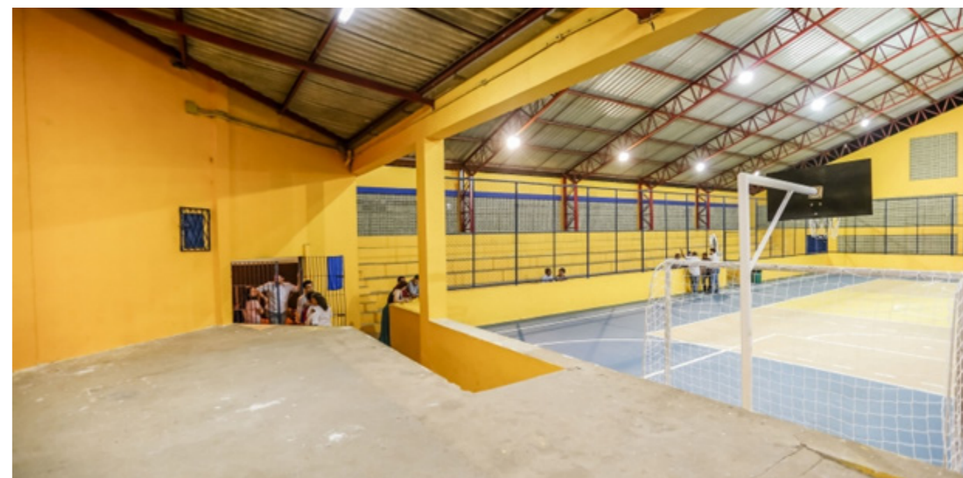
Figura 7 — Centro Popular de Esporte e Lazer da Macaxeira após reforma. Foto: Prefeitura de Recife, 2018.
