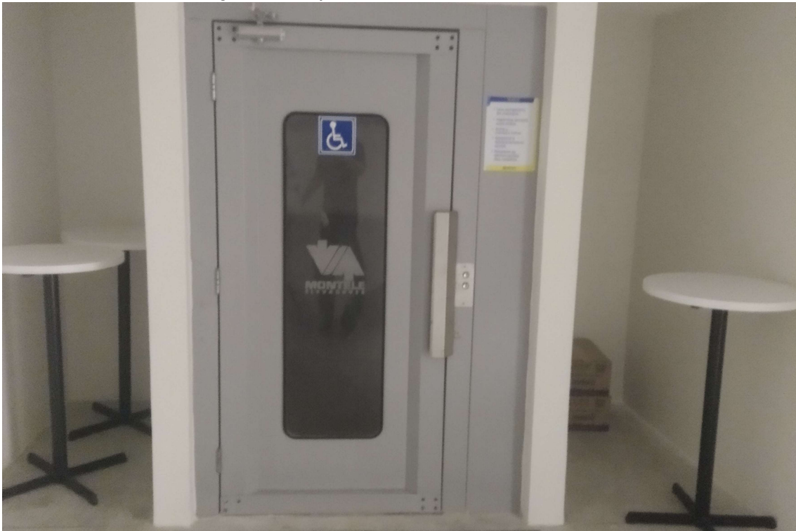
Figura 64 - Plataforma elevatória no acesso exclusivo na tribuna
