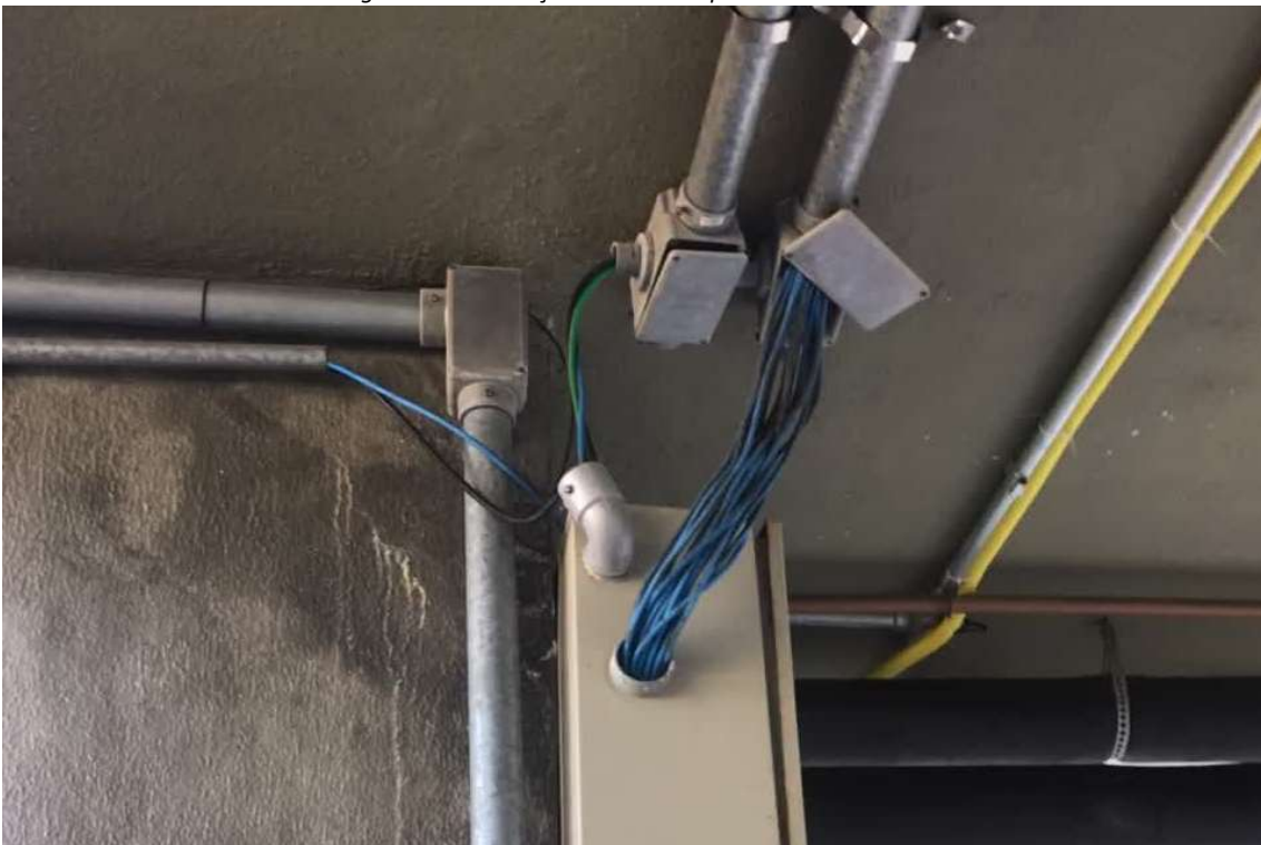
Figura 33 - Instalações de dados aparentes no corredor térreo
