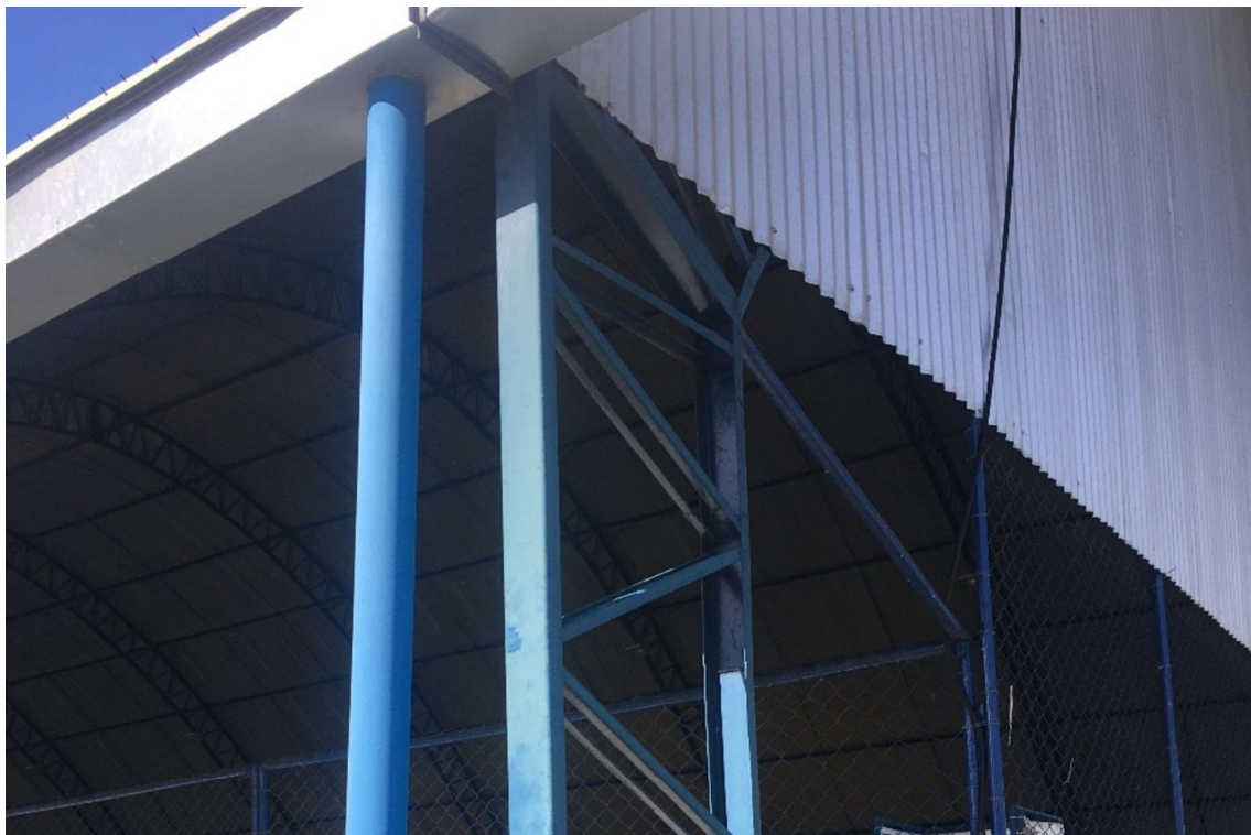
Figura 92 – Estrutura de suporte e calhas
