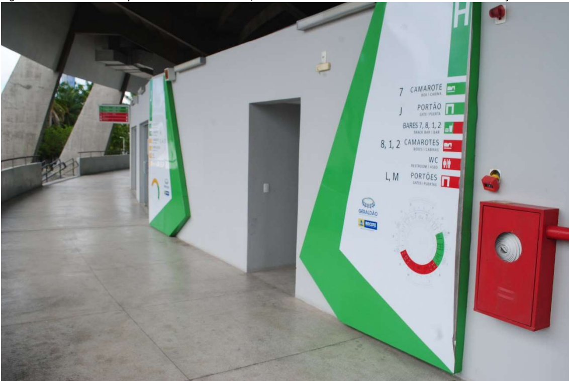
Figura 55 - Corredor do pavimento intermediário, hidrante e sistema de direcionamento e localização existente
