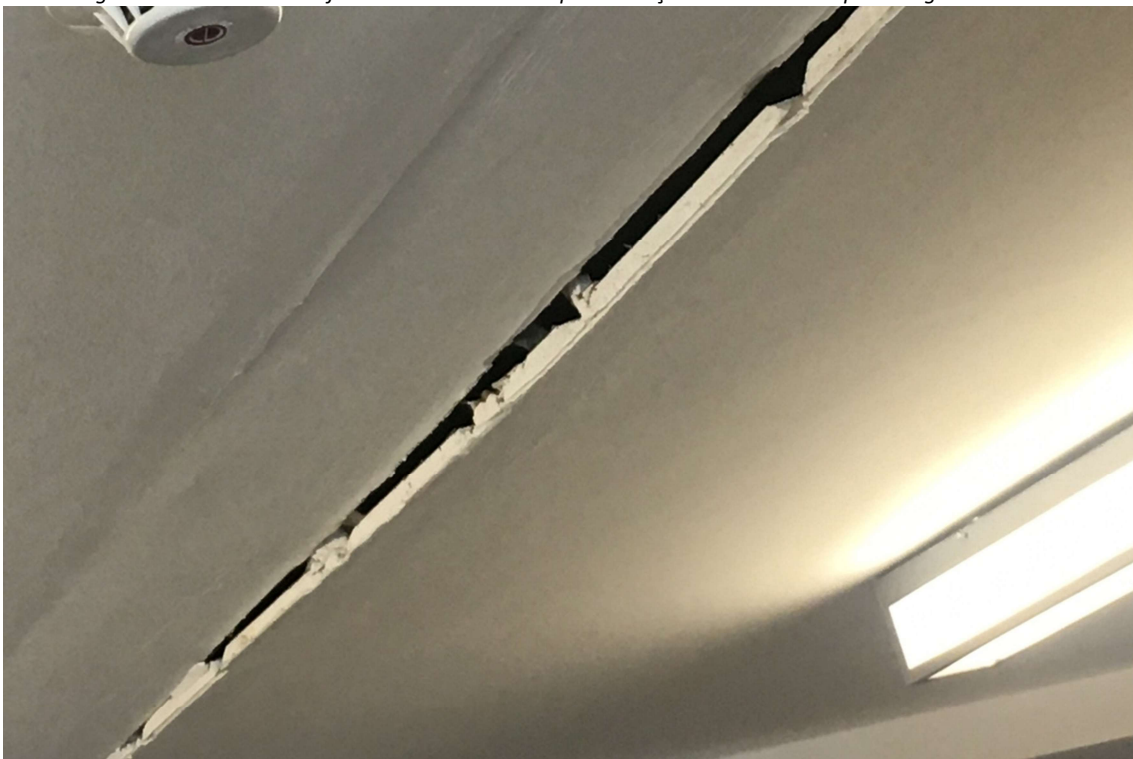
Figura 71 - Selamento do forro da Sala do Acervo pela vibração da casa de máquinas logo acima
