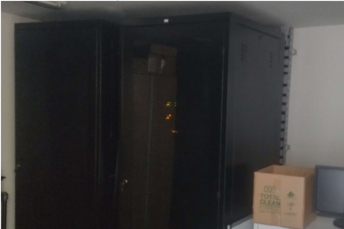
Figura 78 - Data center do COMPLEXO MULTIUSO
