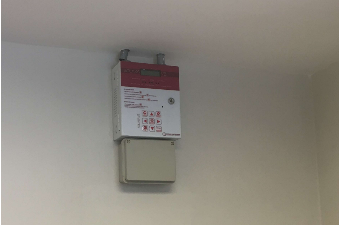
Figura 73 - Central de alarme, já em substituição
