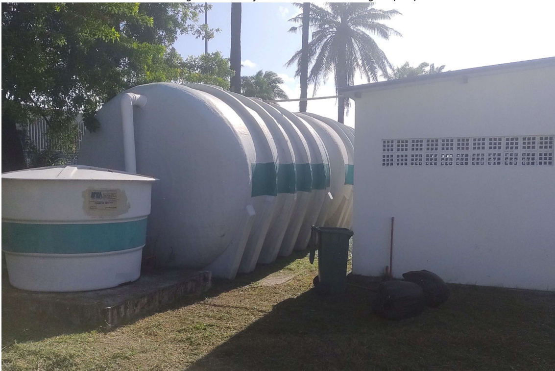
Figura 14 - Estação de tratamento de esgoto (ETE)
