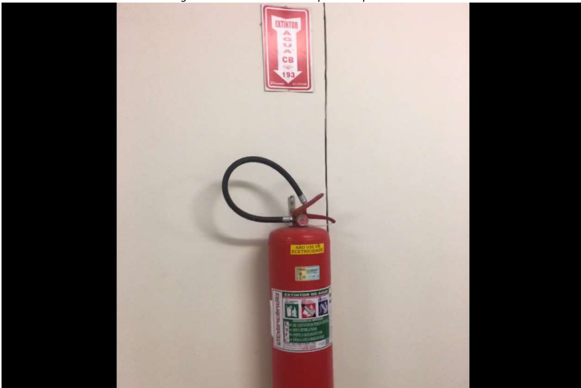
Figura 53 - Extintores do complexo no prazo de validade
