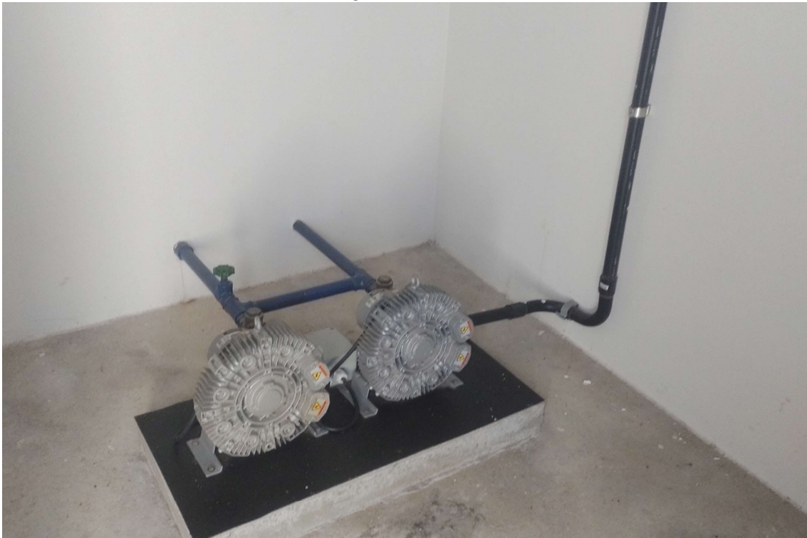
Figura 17 - Bombas da ETE
