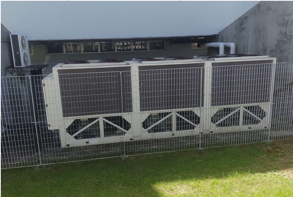
Figura 48 – Um dos chillers do sistema de refrigeração (são quatro ao todo)
