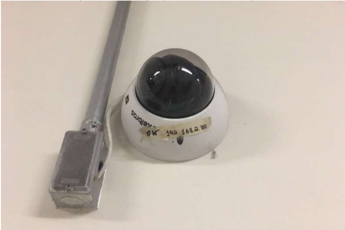
Figura 52- Câmera de segurança interna em bom estado de funcionamento
