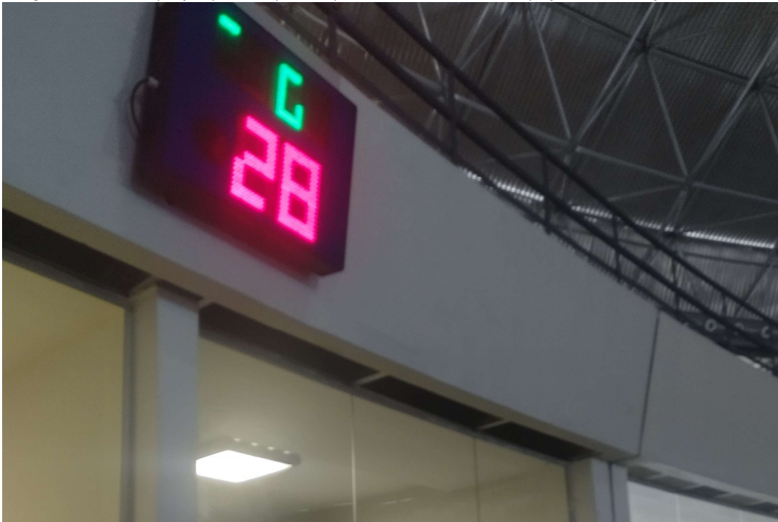
Figura 66 - Placar específico para basquete no pavimento intermediário em perfeito estado de funcionamento
