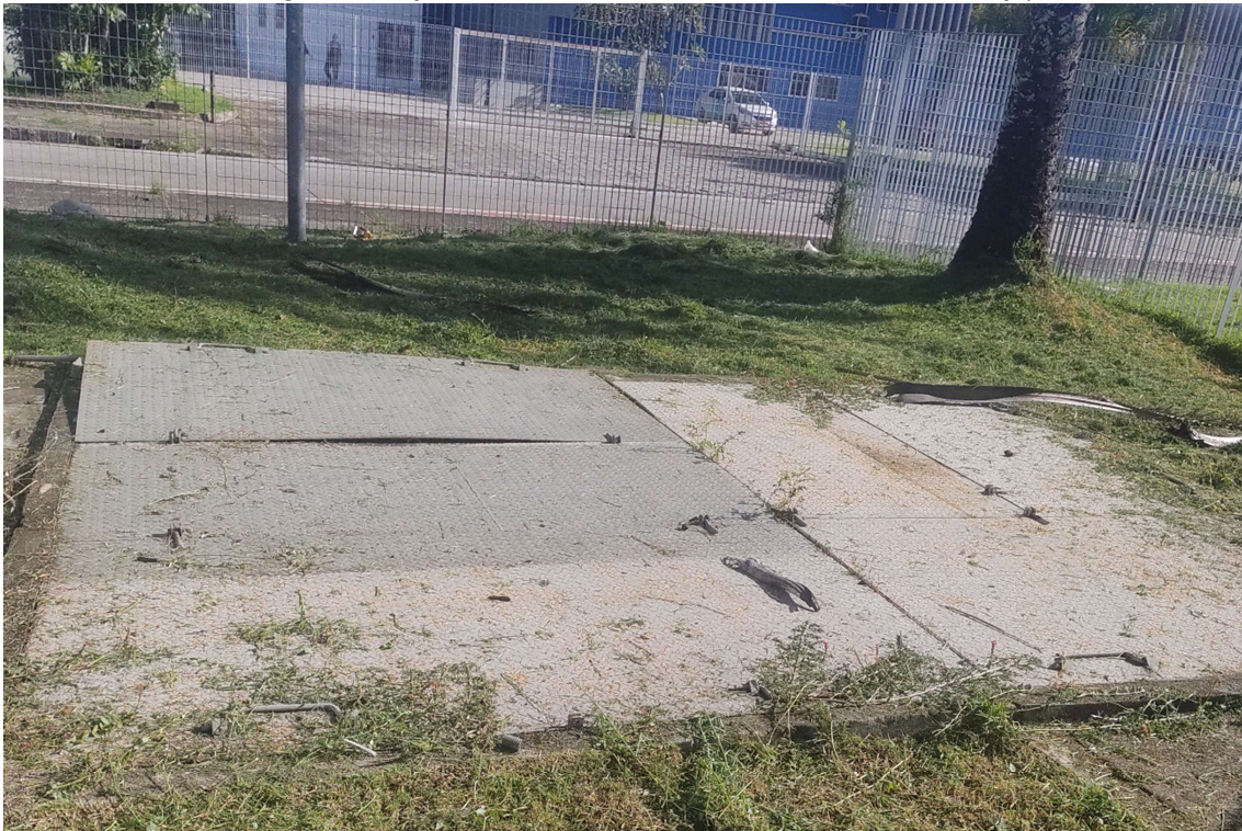
Figura 15 - Poço de recebimento da ETE, devidamente coberto com alçapão
