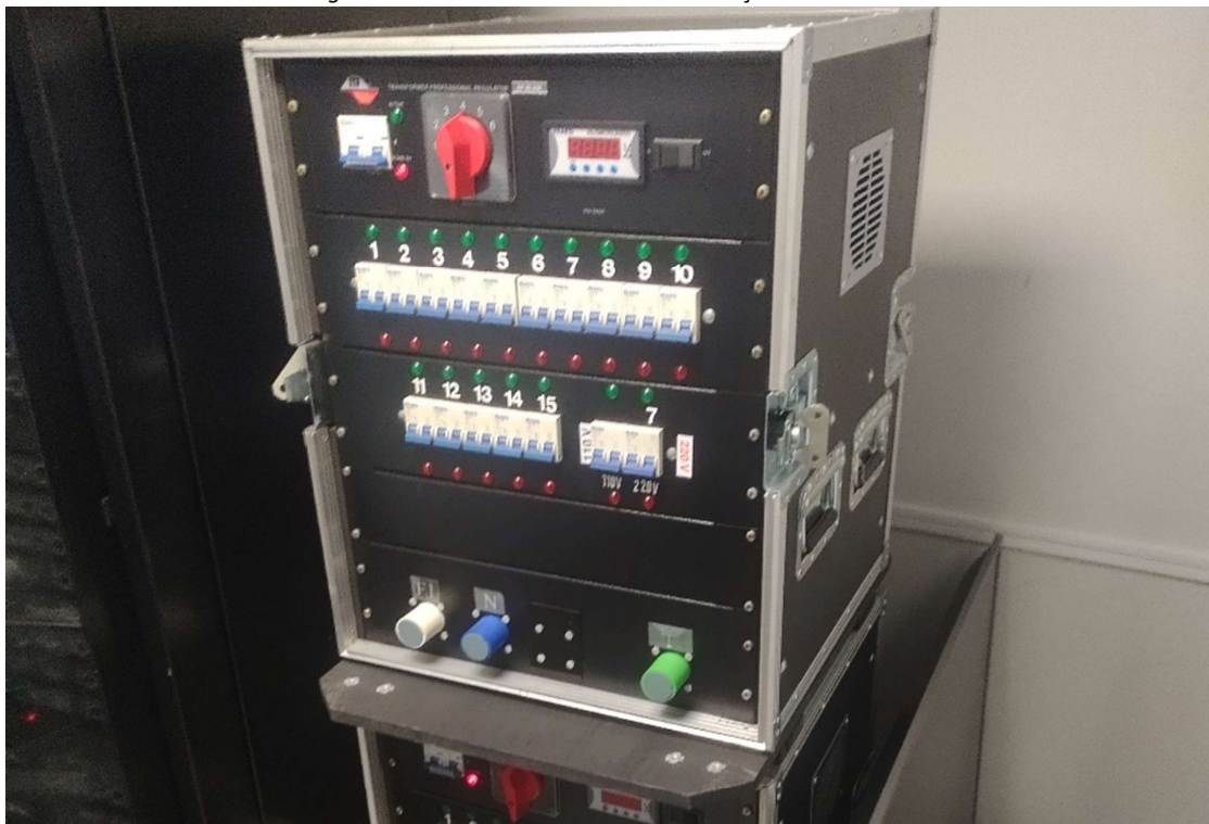
Figura 75 - Rack de comando da sonorização ambiente
