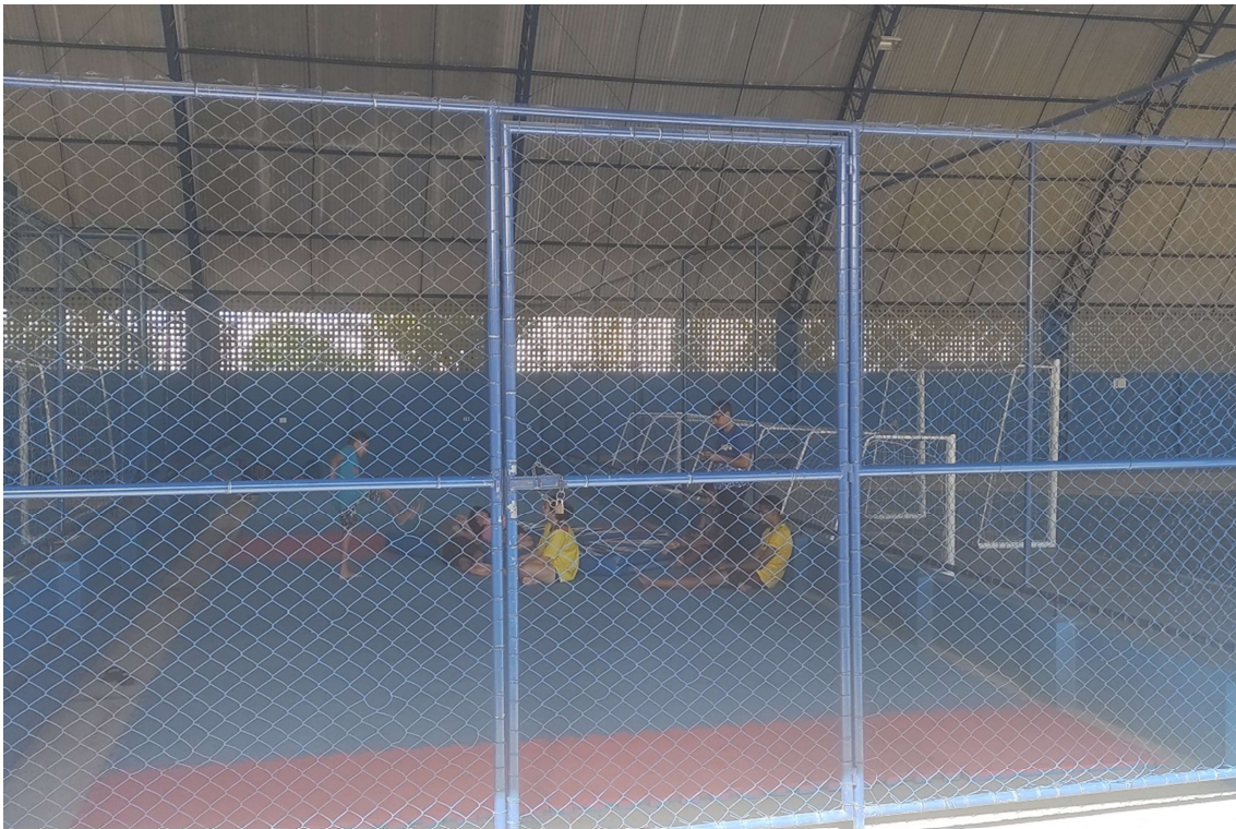
Figura 87 – Portão do alambrado das QUADRAS POLIESPORTIVAS necessitando de retoque
