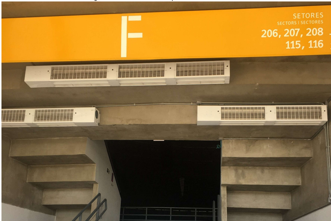
Figura 67 - Cortinas de ar do pavimento intermediário
