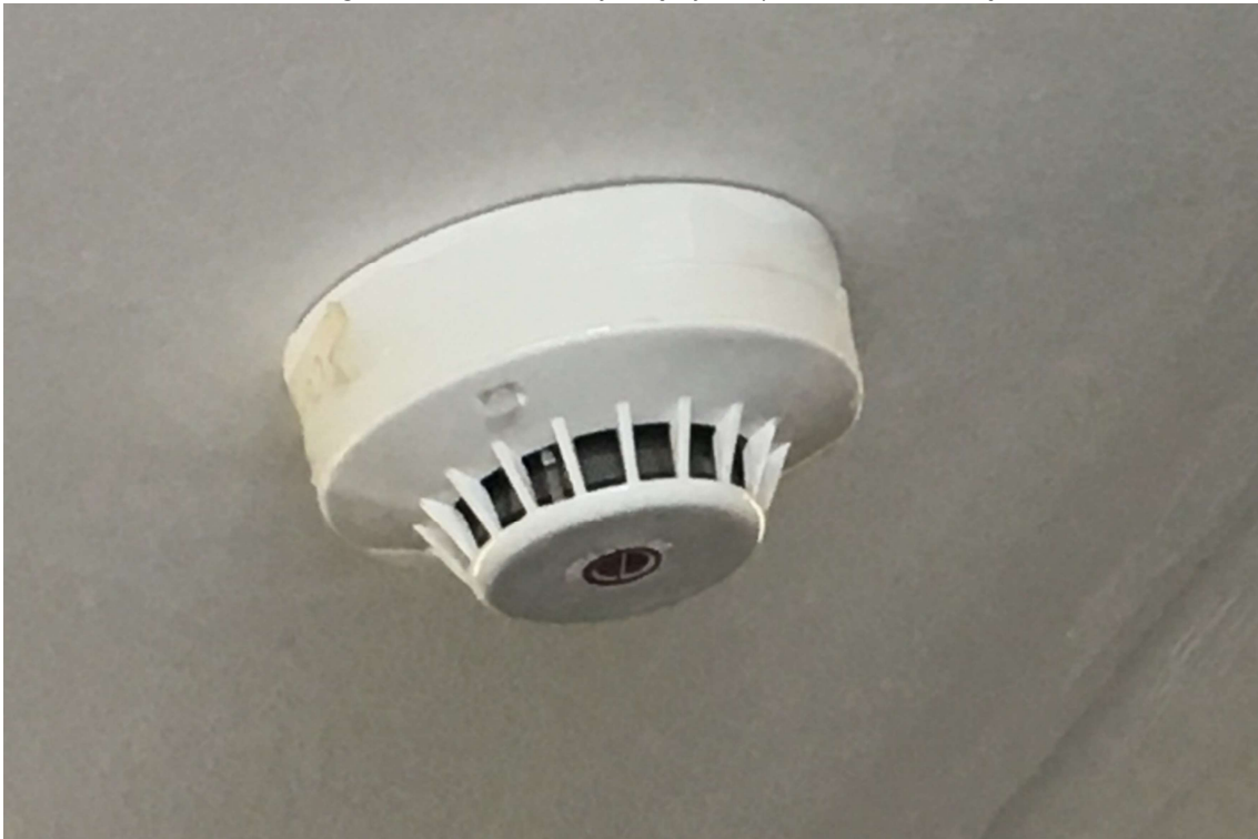
Figura 72 - Detectores de fumaça, já em processo de substituição
