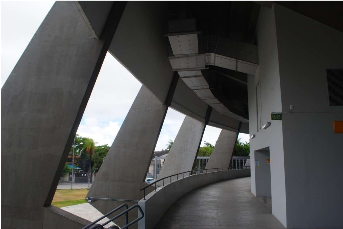
Figura 56 – Acesso à casa de máquinas e dutos de direcionamento de ar no pavimento intermediário
