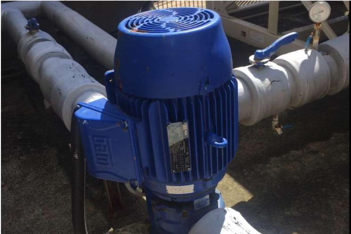
Figura 50 - Bomba para recalque de água gelada do chiller para as casas de máquinas
