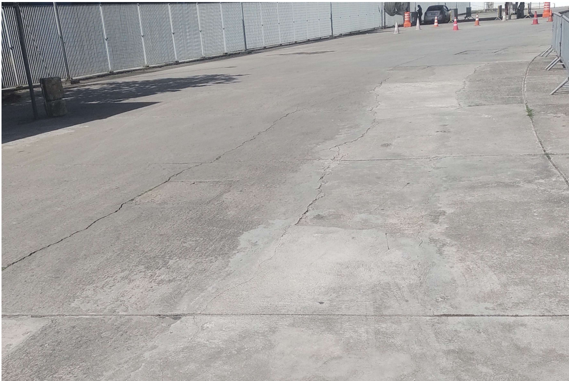
Figura 113 – Piso do ESTACIONAMENTO DE SERVIÇO necessitando de reparos
