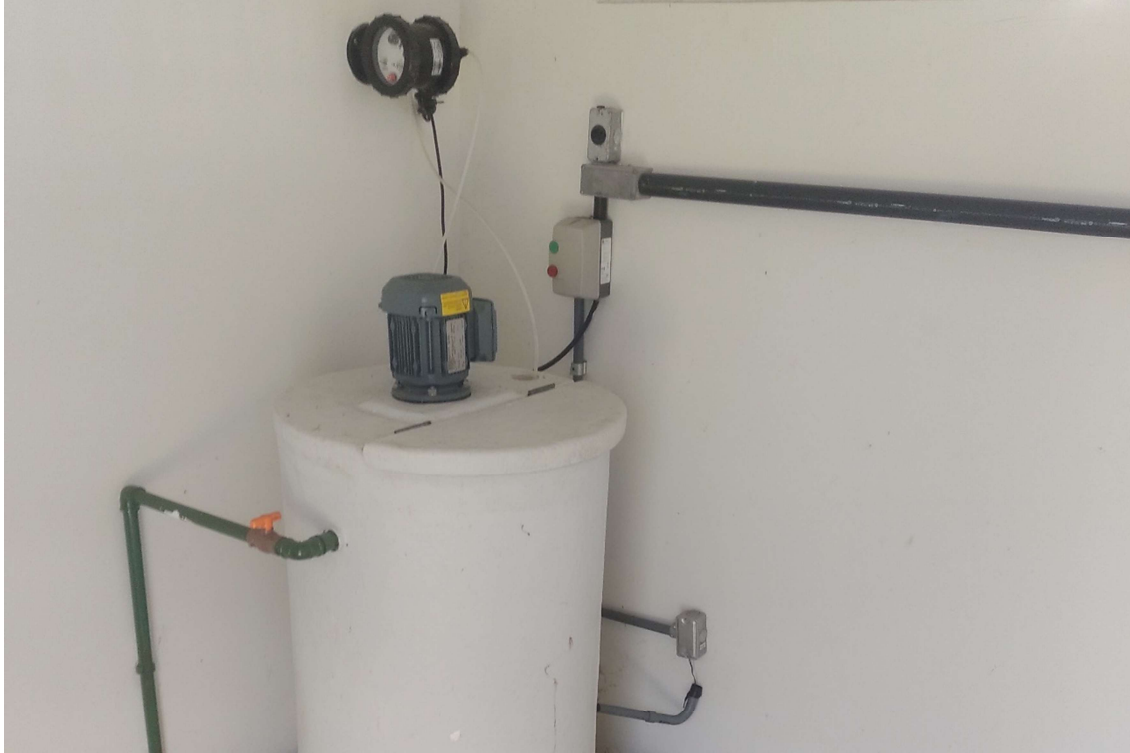
Figura 16 - Equipamentos para cloração do efluente da ETE
