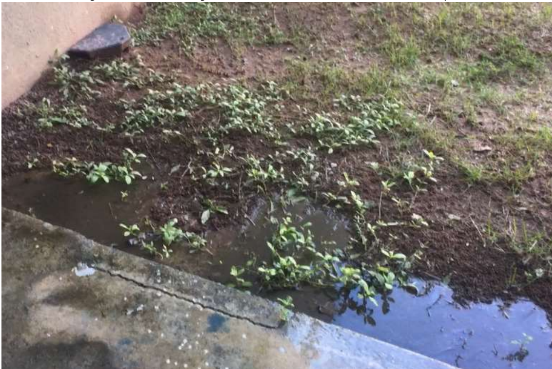
Figura 31 - Acúmulo de água de condensadores de condicionadores de ar no piso do térreo
