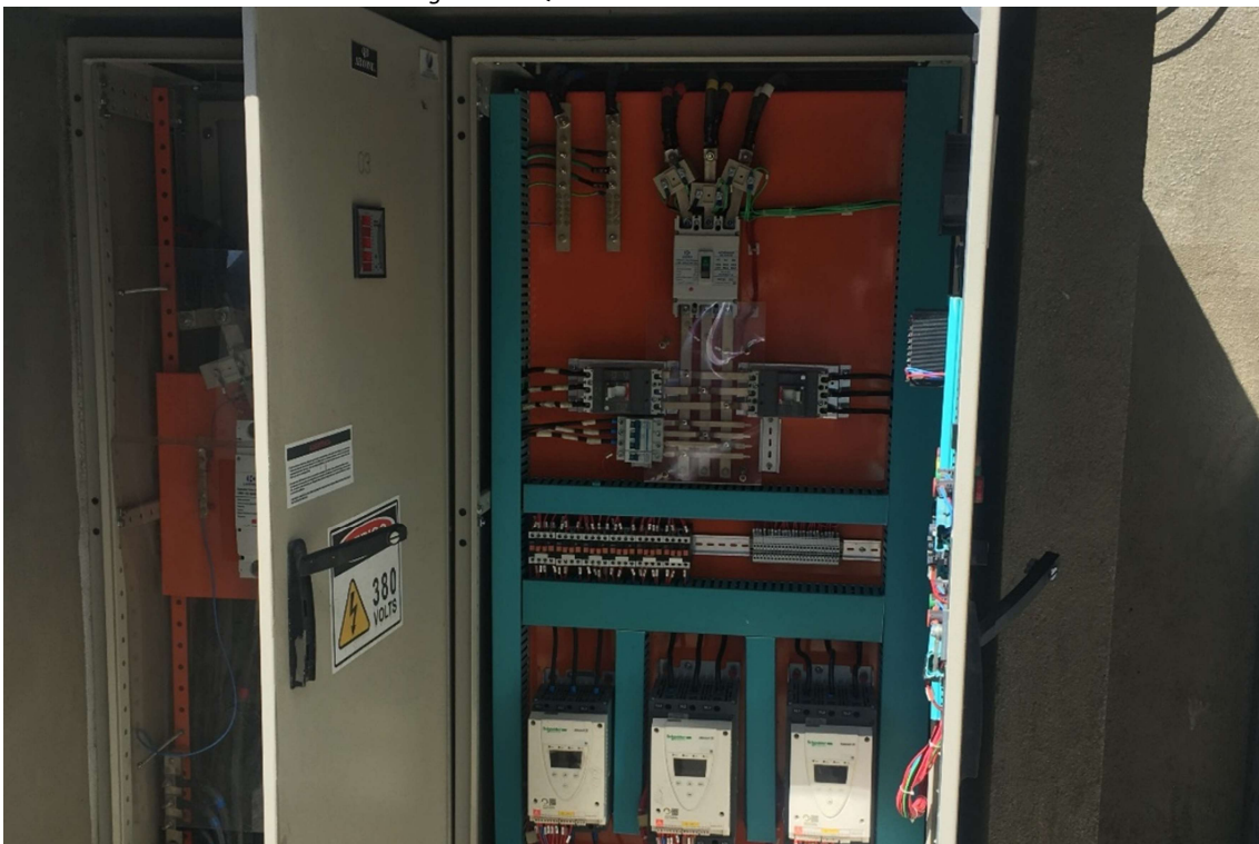
Figura 49 - Quadro de comando do chiller
