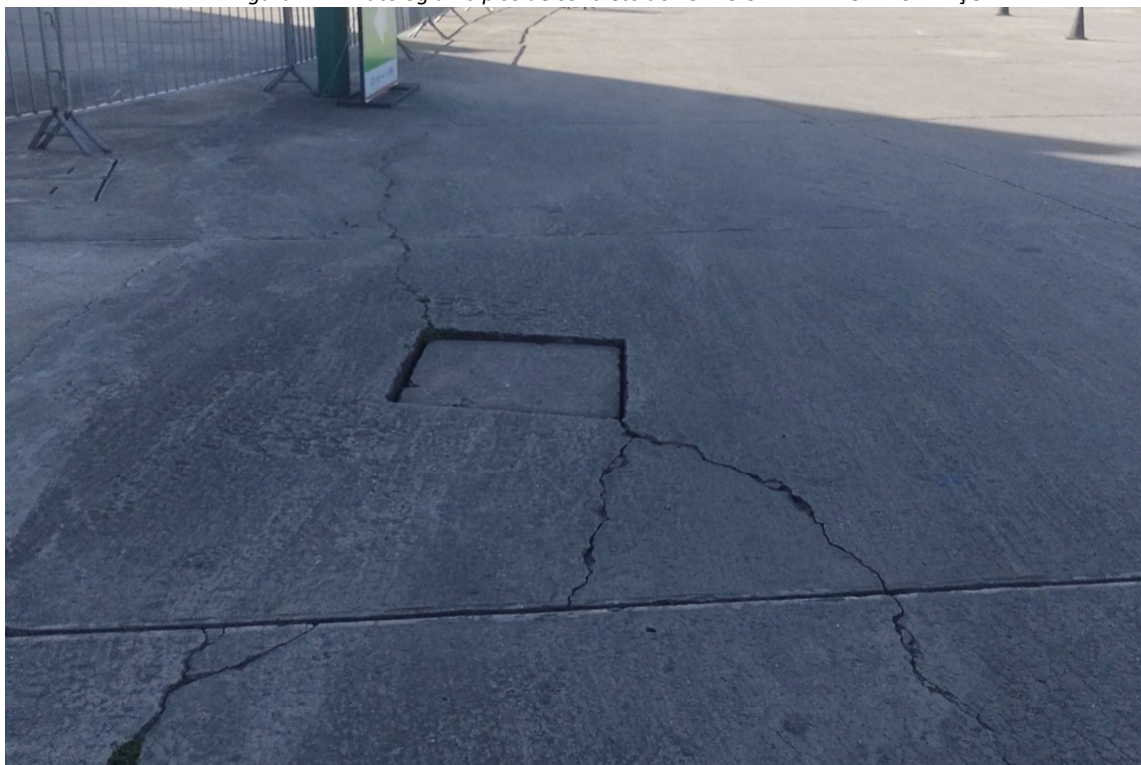
Figura 117 - Patologia no piso de concreto do ESTACIONAMENTO DE SERVIÇO
