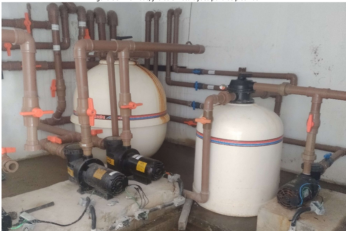
Figura 98 - Bombas, filtros e instalações para as piscinas
