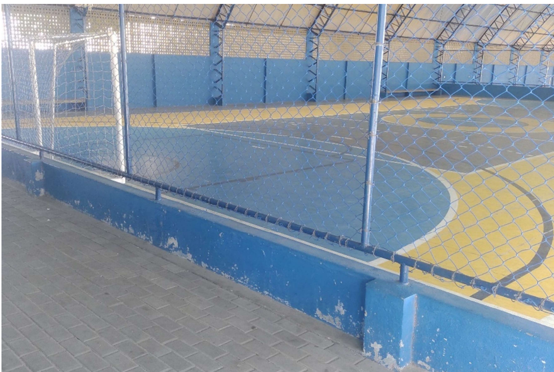
Figura 86 –Alambrados das QUADRAS POLIESPORTIVAS e mureta necessitando de retoque
