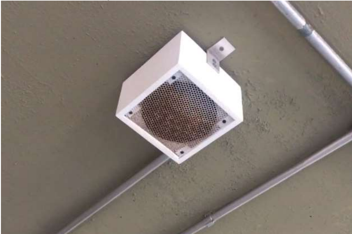
Figura 74 - Caixas de som ambiente da ARENA MULTIUSO
