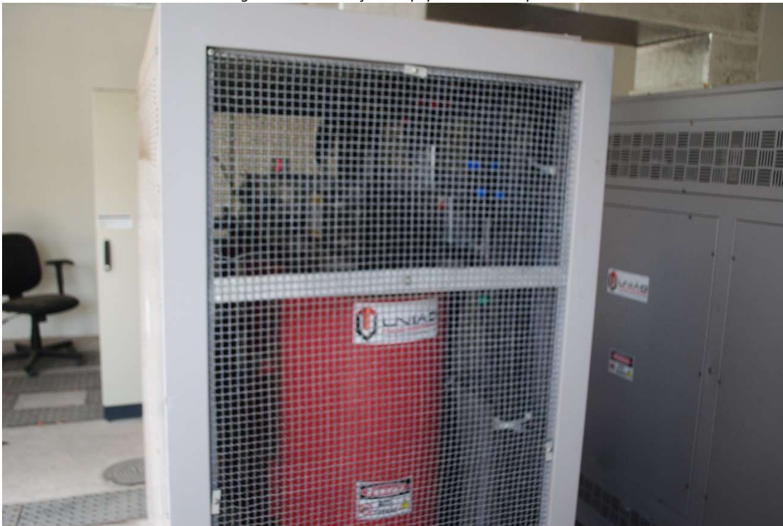
Figura 12 - Subestação – equipamentos complementares
