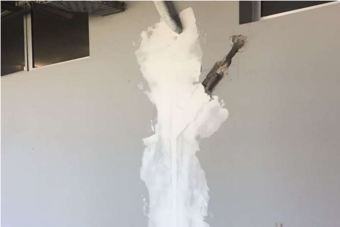
Figura 32 - Necessidade de acabamento de pintura na parede externa do térreo
