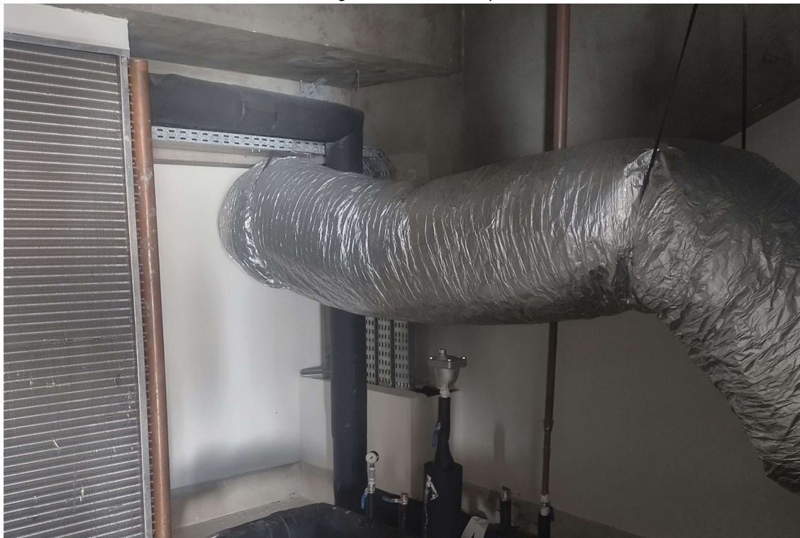
Figura 69 - Casa de máquinas
