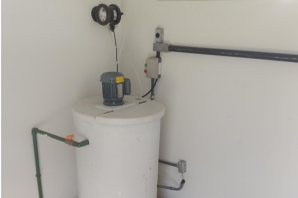
Figura 16 - Equipamentos para cloração do efluente da ETE
