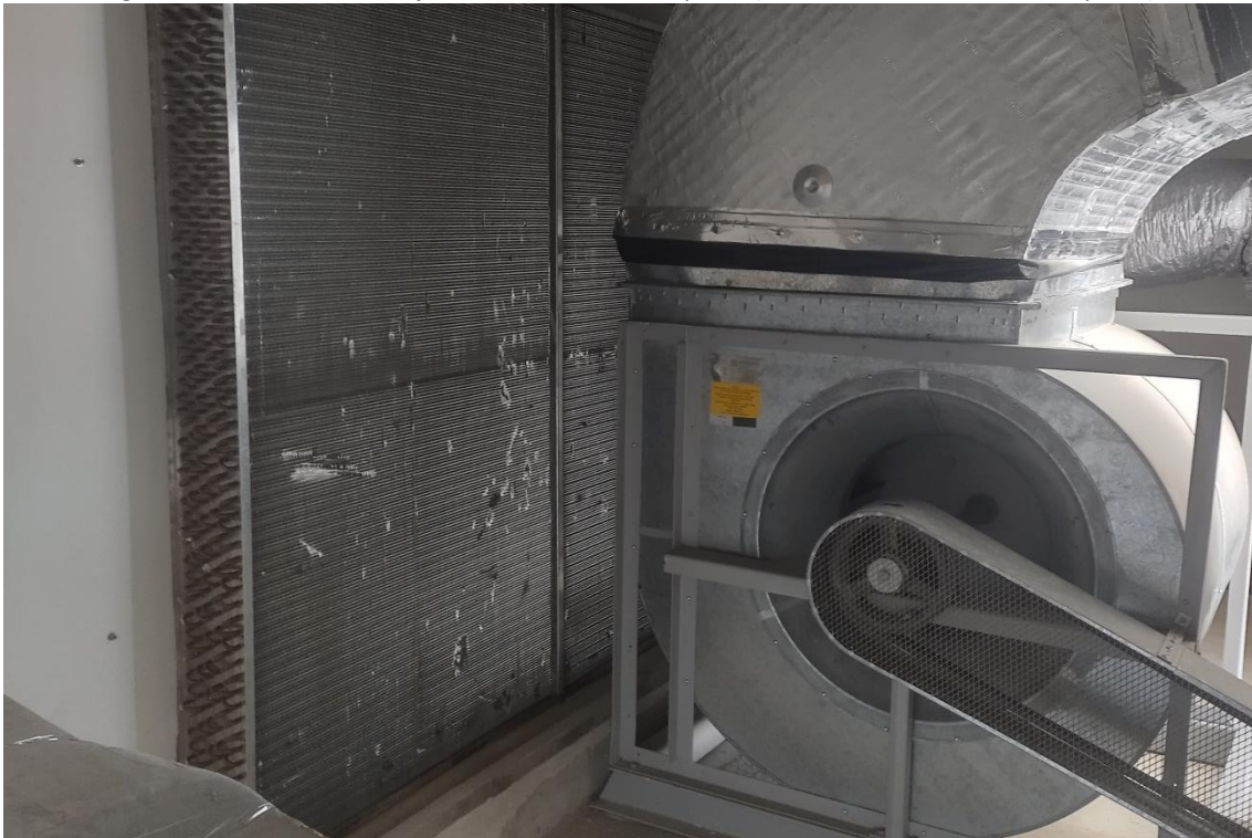
Figura 70 - Ventilador de insuflamento da casa de máquinas (idêntico nas oito casas de máquinas)
