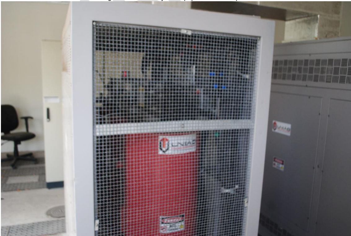
Figura 12 - Subestação – equipamentos complementares
