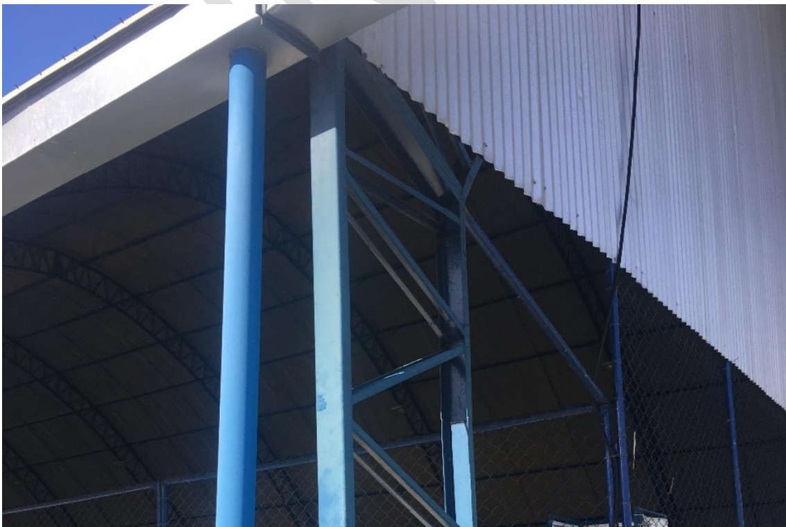
Figura 92 – Estrutura de suporte e calhas
