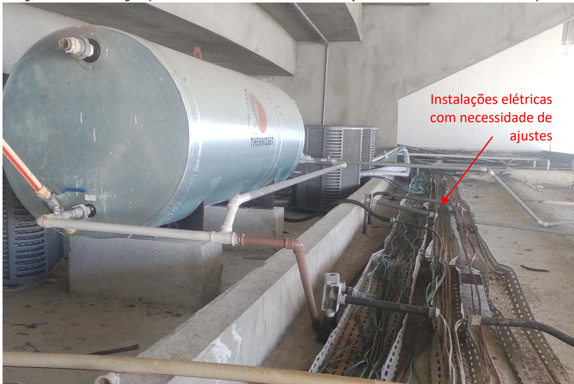
Figura 40 - Boiler de água quente dos vestiários dos atletas e instalações elétricas com necessidades de reparos
