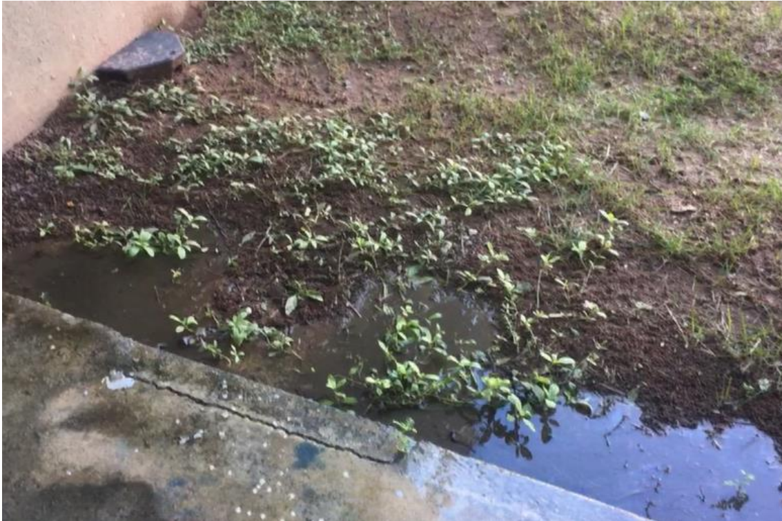
Figura 31 - Acúmulo de água de condensadores de condicionadores de ar no piso do térreo
