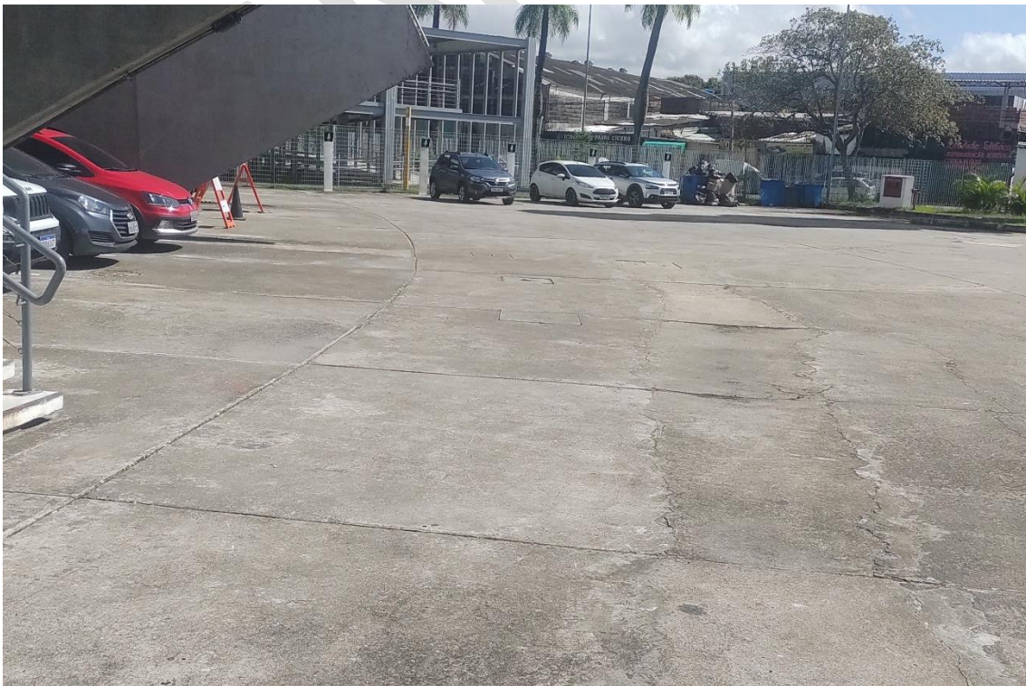
Figura 115 – Vagas para imprensa e visão do piso do com a necessidade de reparos
