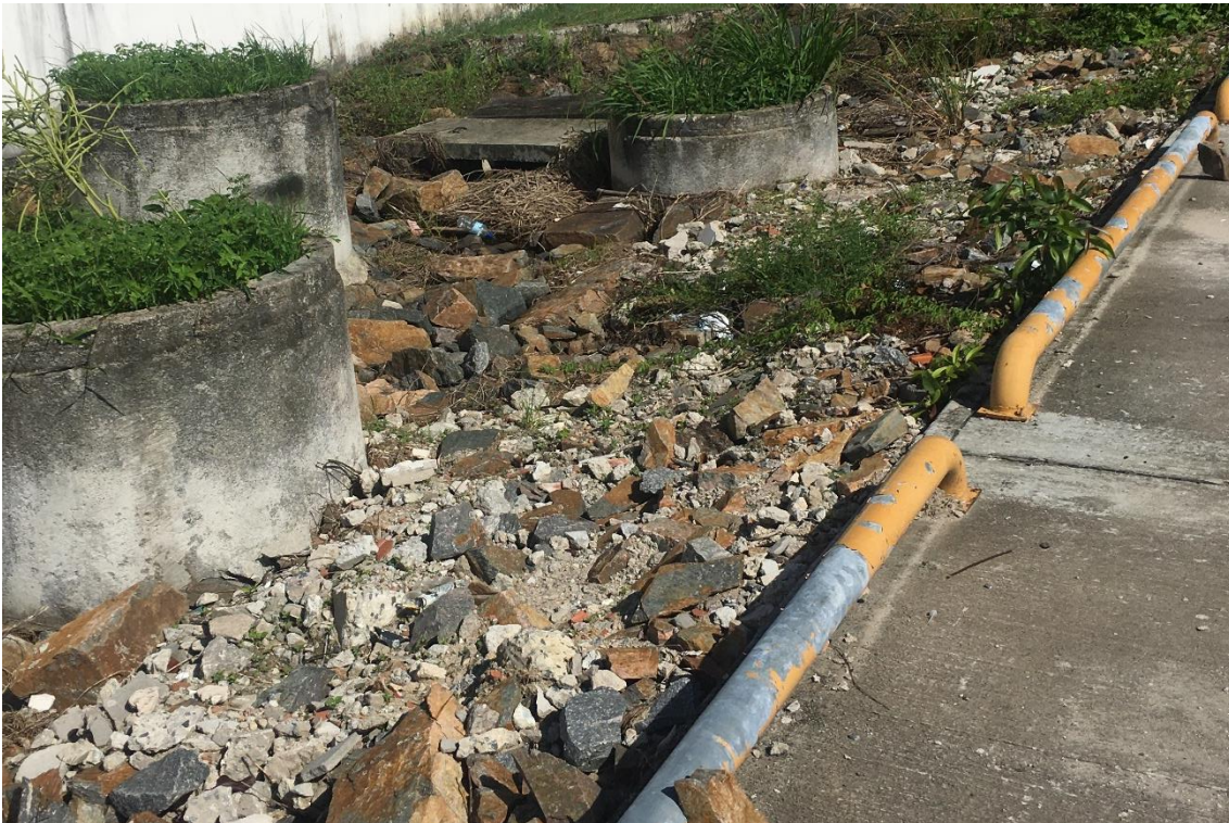
Figura 111 – Área para drenagem de águas pluviais com necessidade de manutenção
