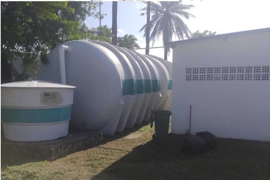
Figura 14 - Estação de tratamento de esgoto (ETE)
