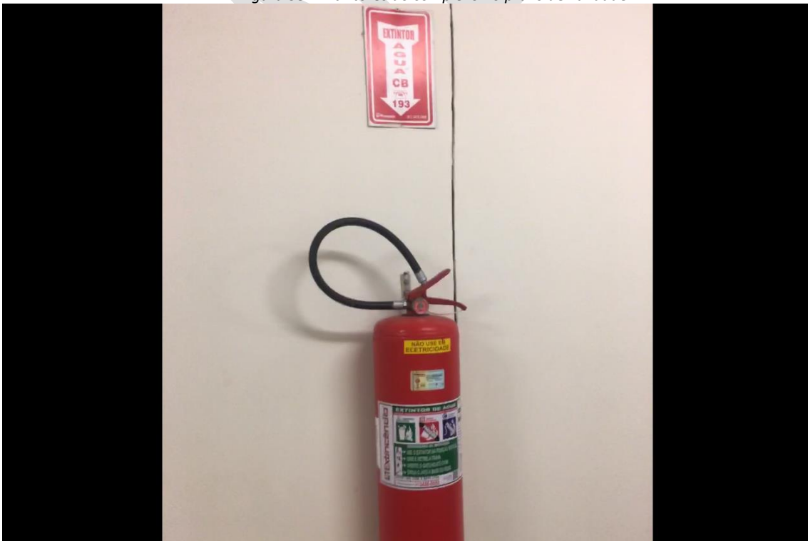
Figura 53 - Extintores do complexo no prazo de validade
