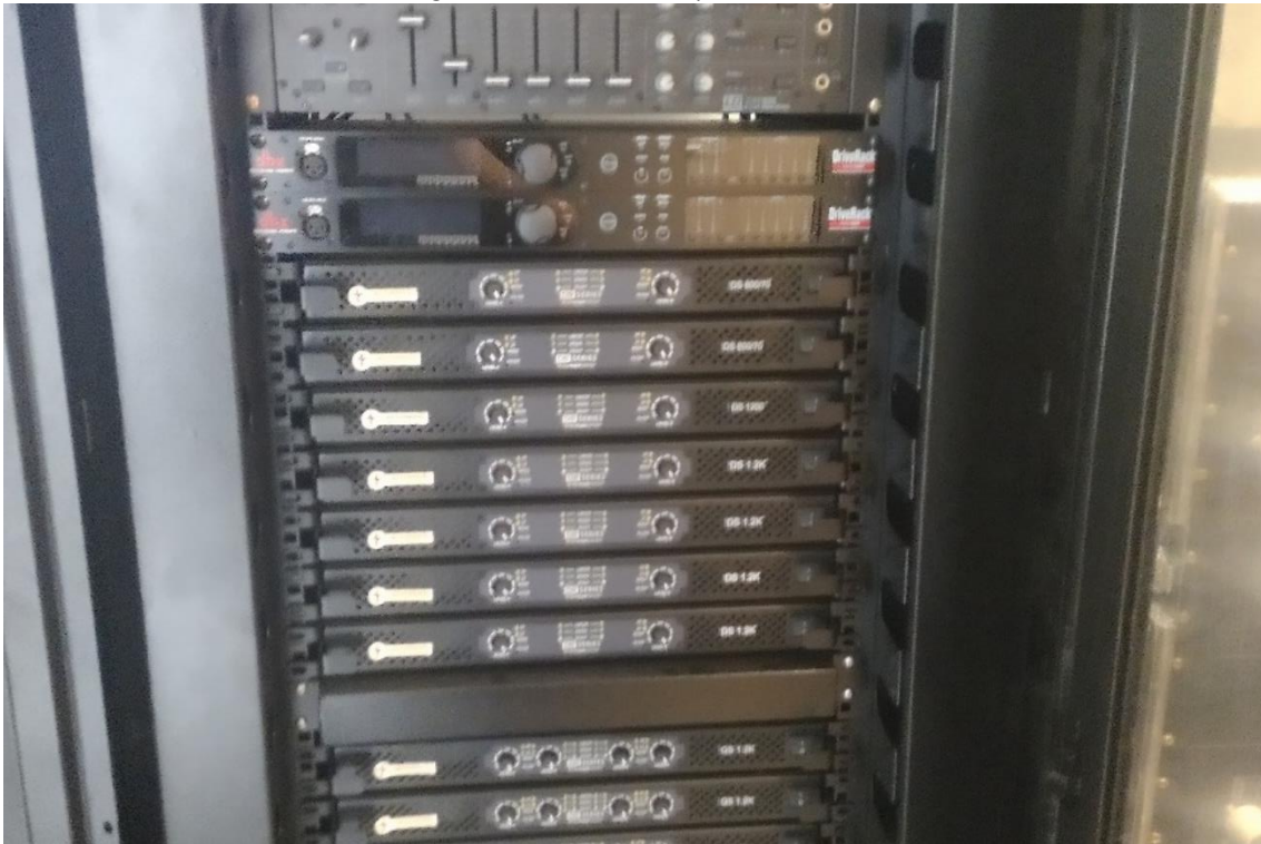
Figura 76 - Rack de dados para o sistema de som
