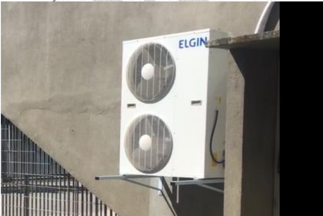
Figura 51 - Condensador dos condicionadores de ar das salas da ARENA MULTIUSO
