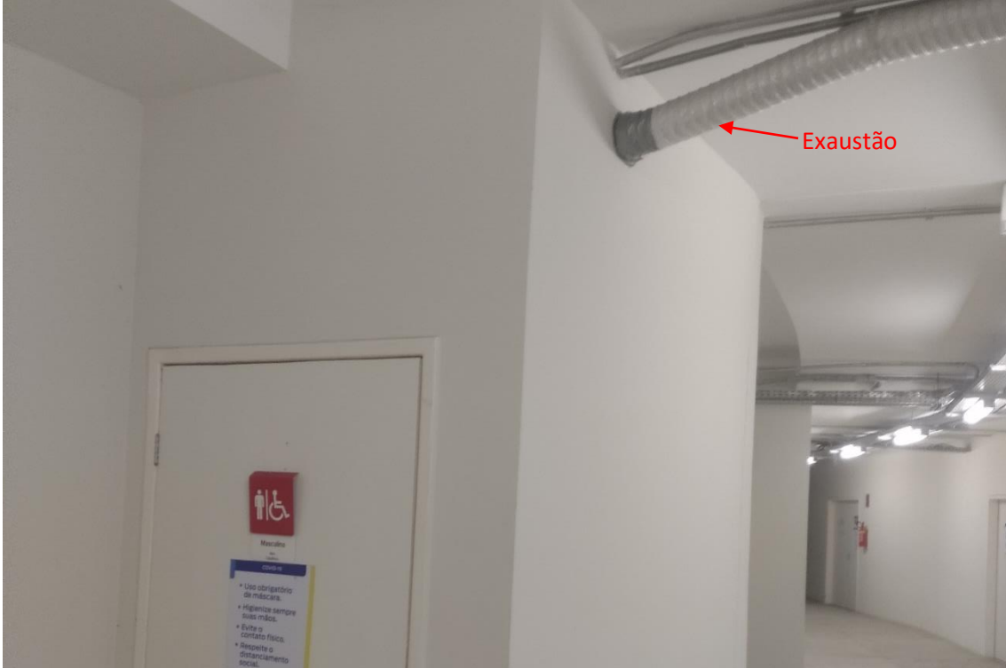
Figura 37 - Banheiros acessíveis no térreo e tubulação de exaustão
