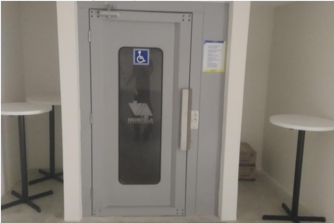
Figura 64 - Plataforma elevatória no acesso exclusivo na tribuna
