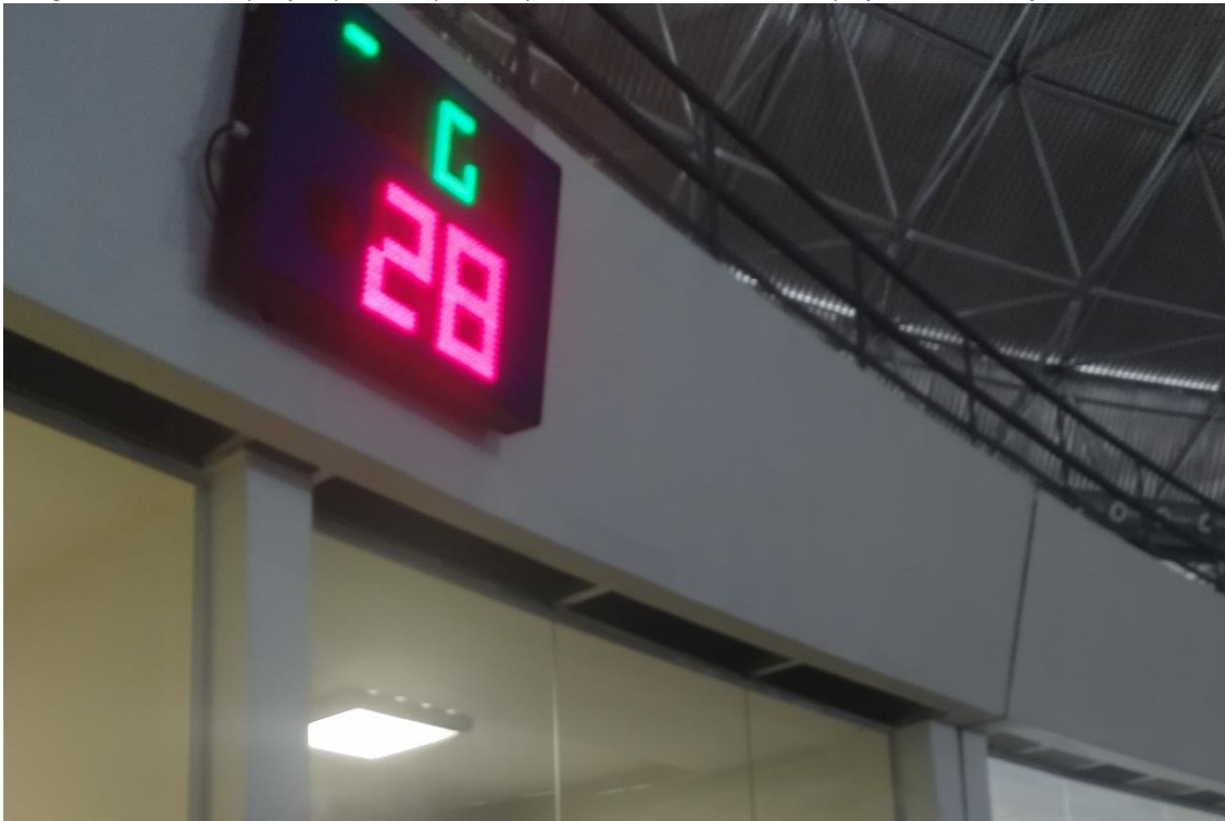
Figura 66 - Placar específico para basquete no pavimento intermediário em perfeito estado de funcionamento
