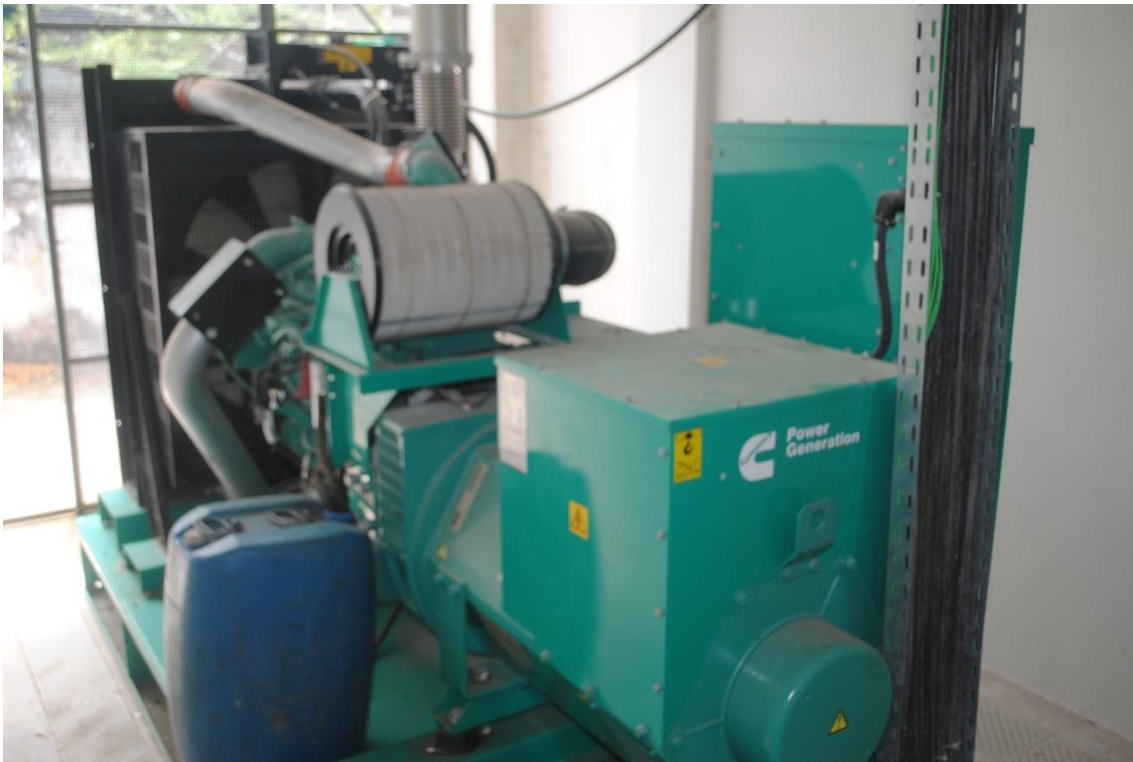
Figura 13 - Gerador para circuito de emergência do COMPLEXO MULTIUSO
