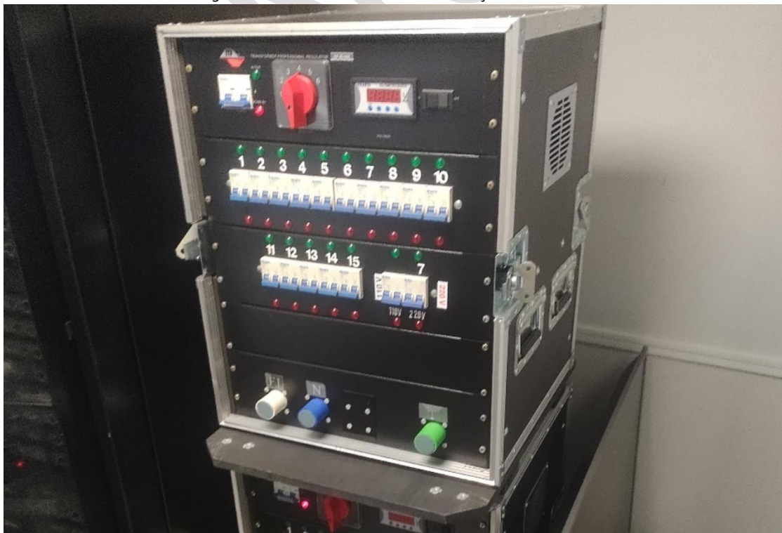
Figura 75 - Rack de comando da sonorização ambiente
