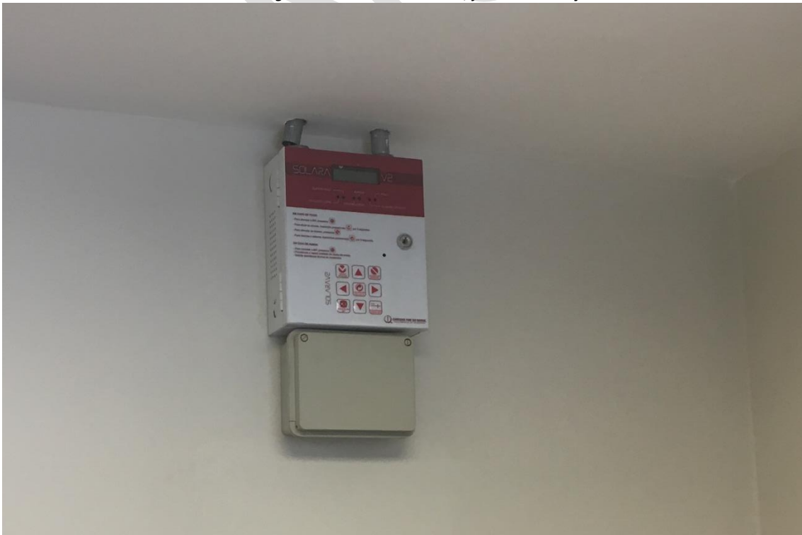
Figura 73 - Central de alarme, já em substituição
