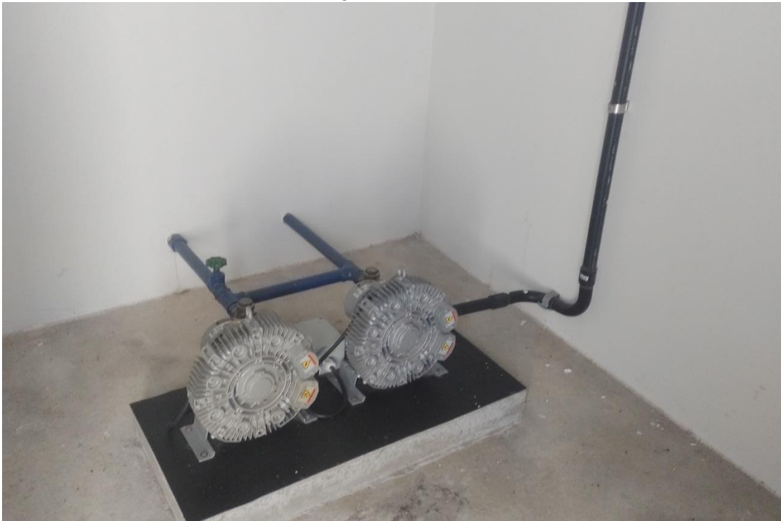
Figura 17 - Bombas da ETE
