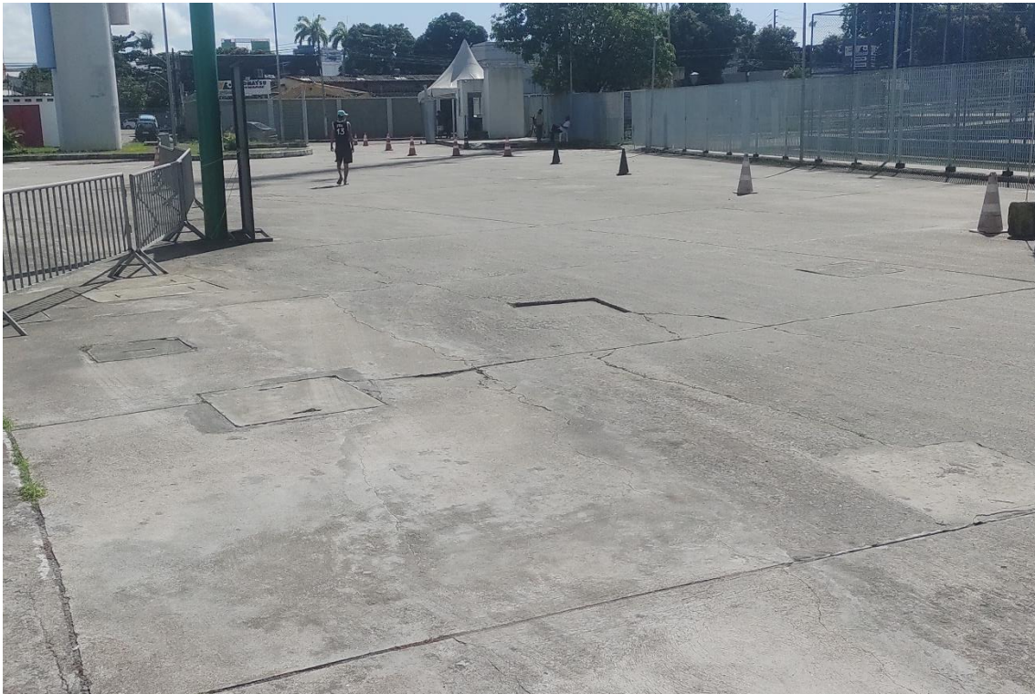
Figura 112 – Piso do ESTACIONAMENTO DE SERVIÇO necessitando de reparos
