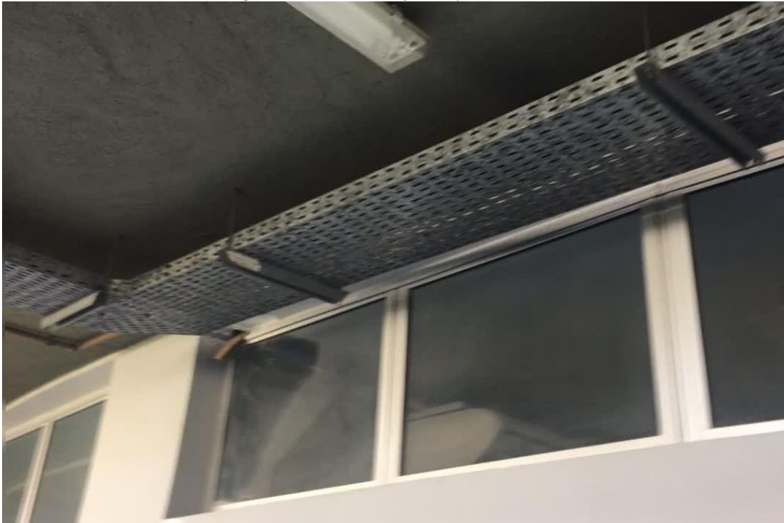
Figura 34 - Eletrocalhas e janelas para as salas no térreo
