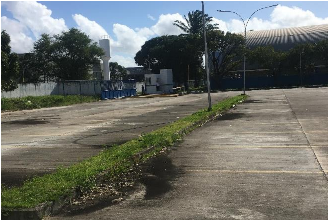
Figura 109 – Piso com necessidade de ajustes para redução do empoçamento
