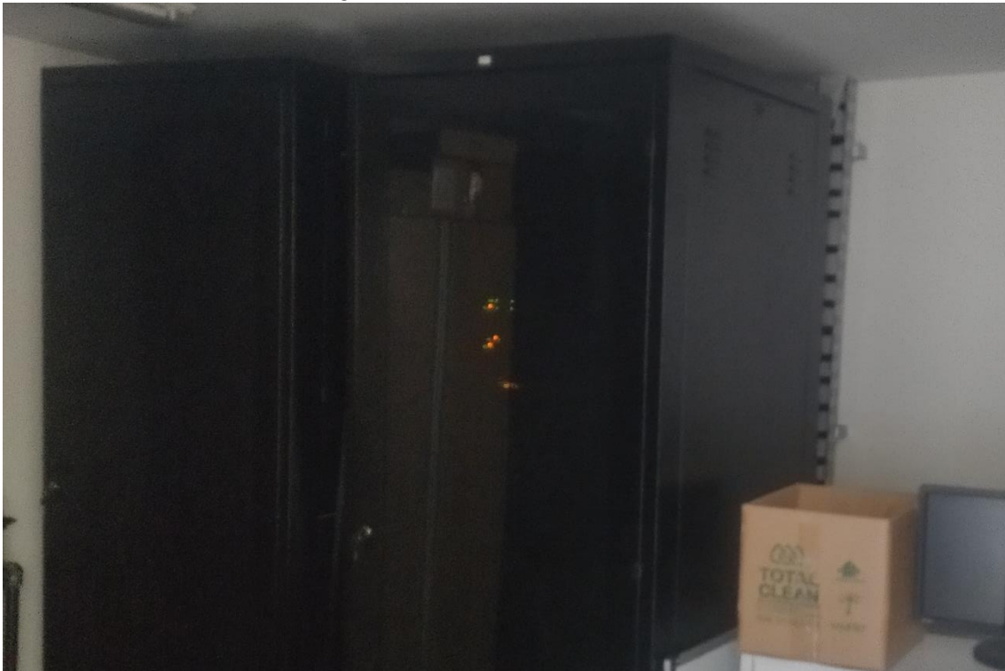
Figura 78 - Data center do COMPLEXO MULTIUSO
