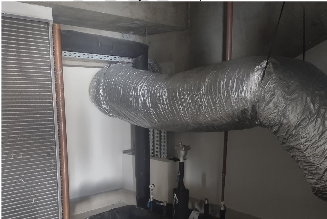
Figura 69 - Casa de máquinas
